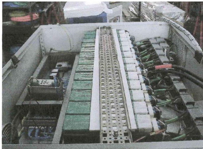
Figura 5. Foto del modulo batteria oggetto di analisi
