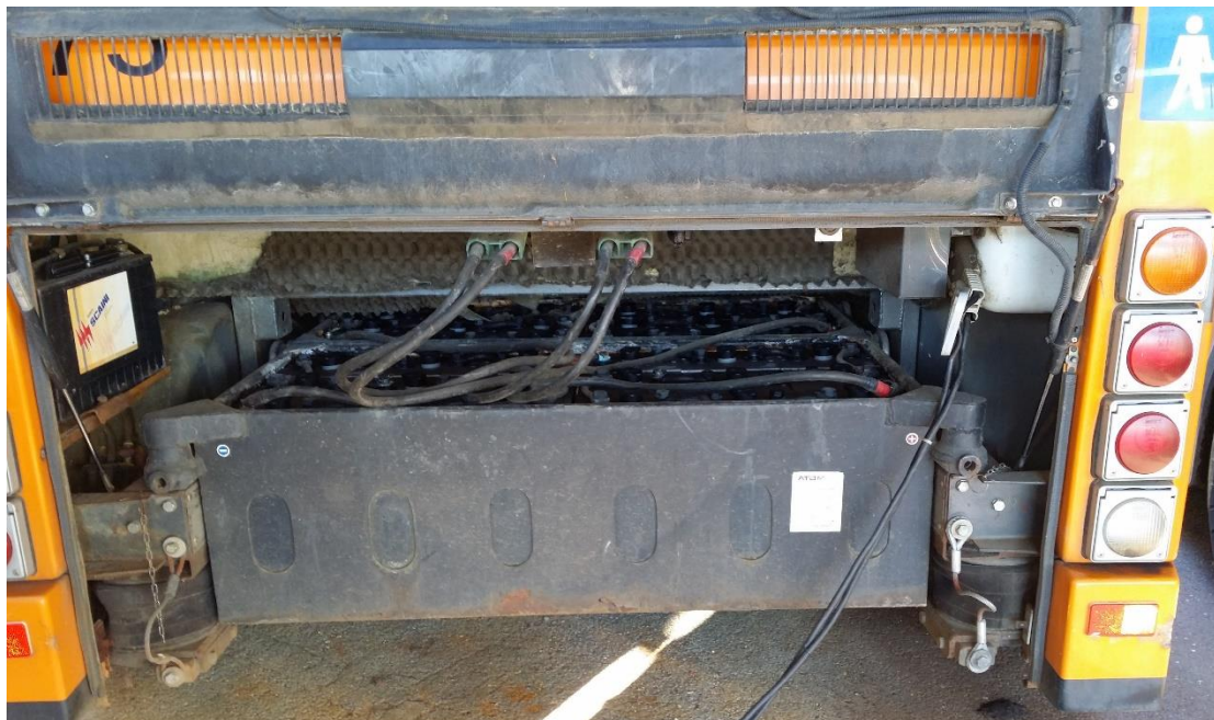
Figura 4 Un dettaglio delle batterie installate sul veicolo TECNOBUS durante la ricarica
