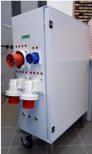
Sezione ingresso con prese di test e interfaccia segnali
