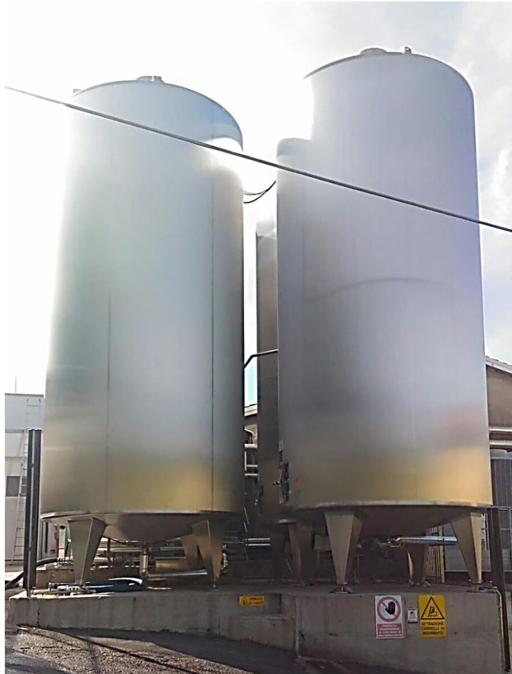
Figura 9: Serbatoi stoccaggio siero
