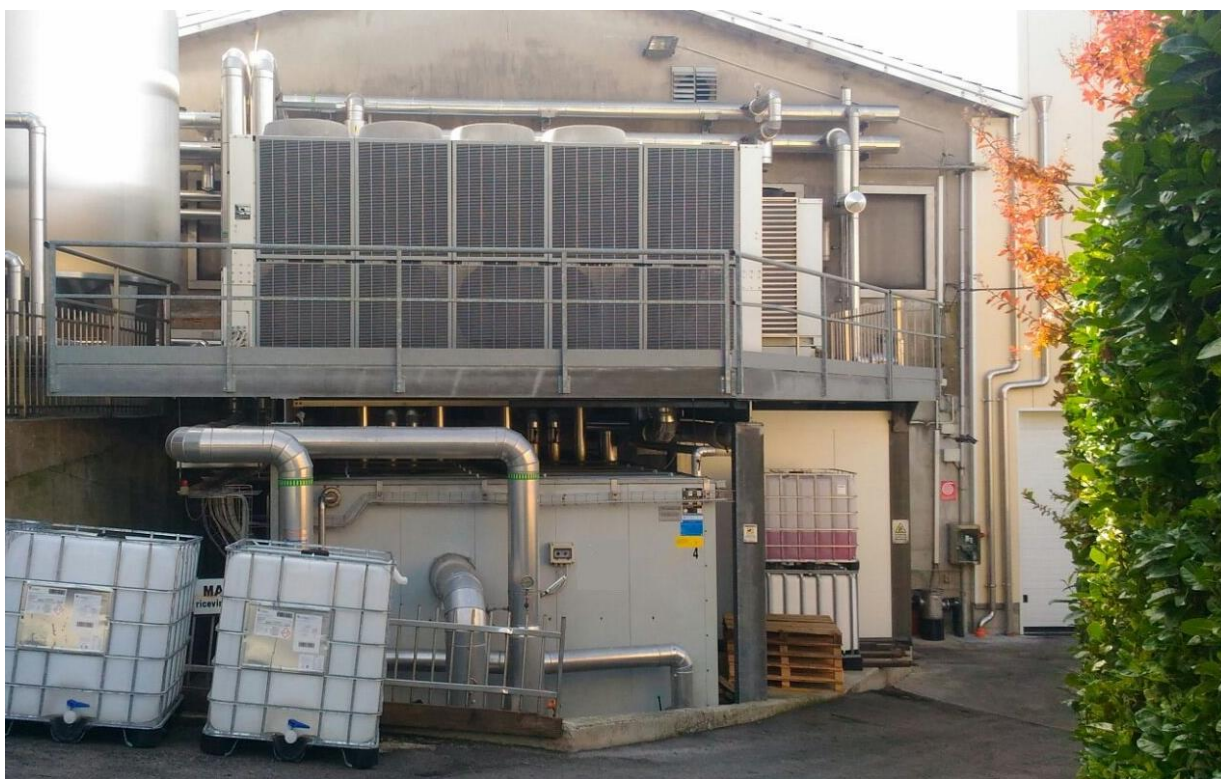
Figura 7: Vasca Acqua Gelida e Chiller 3 e 4
