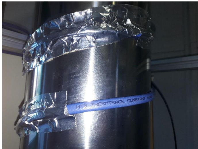
Figura 3.9 Foto del cavo scaldante avvolto sul condotto del letto MOF in fase di montaggio
