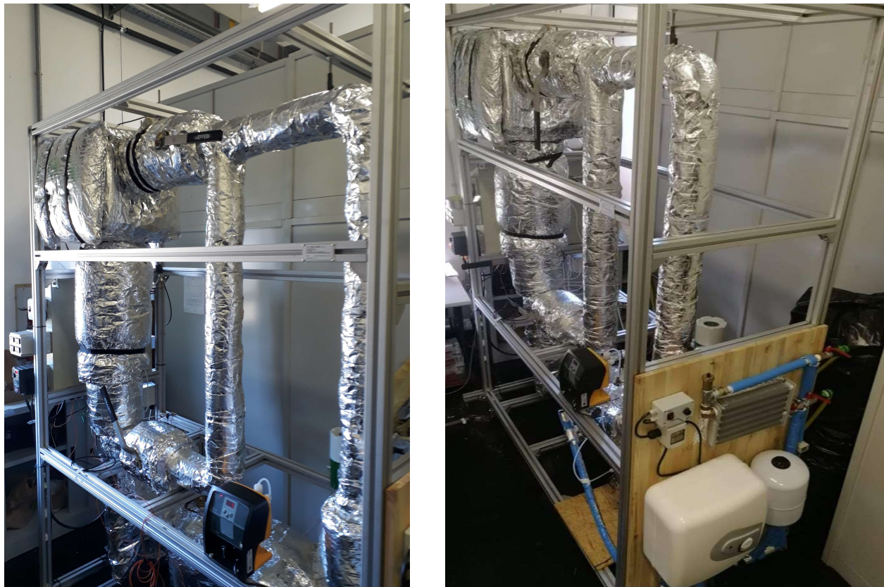
Figura 2.3. Foto del nuovo sistema STEAM approntato in laboratorio con coibentazione (SX) e particolare del sistema di termostatazione dell'acqua di alimentazione del condensatore (DX).
