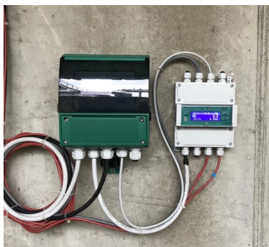
Figura 5 Assorbimento elettrico alla caldaia
