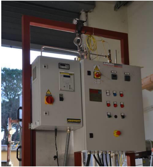
Figura 10. a) Quadro di controllo dell'impianto
