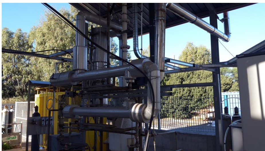
Figura 2.1. Vista frontale dell'impianto IOSTO.
