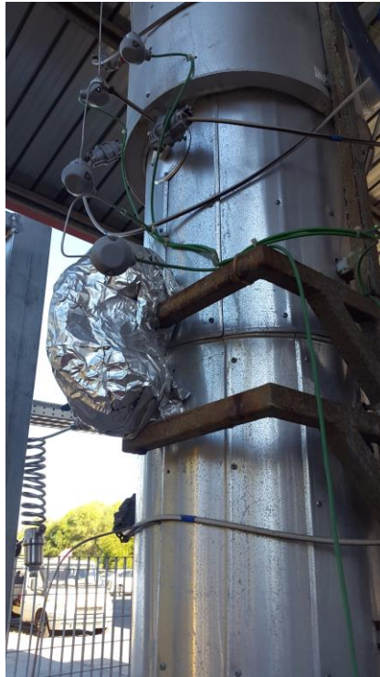
Figura 3.1. Coibentazione intercooler tra i due stadi del reattore.
