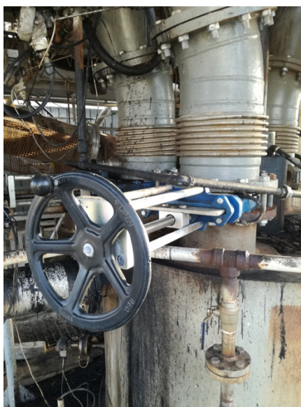
Figura 13. Ghigliottine di intercettazione dei condotti di adduzione della biomassa
