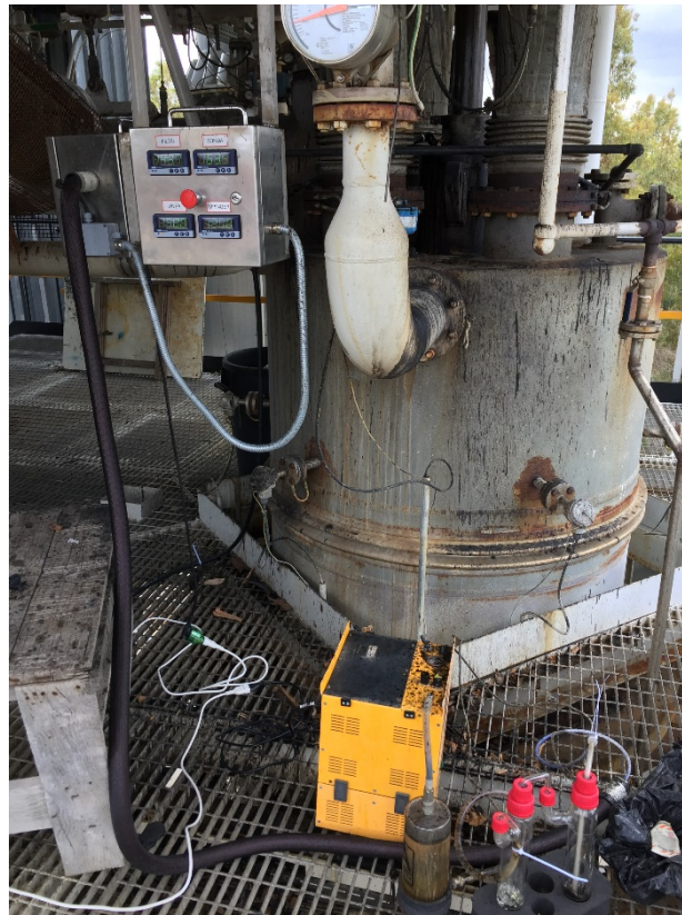
Figura 9. Sistema complessivo campionamento TAR
