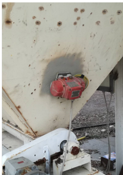
Figura 14. Vibrovaglio installato sulla tramoggia del Redler
