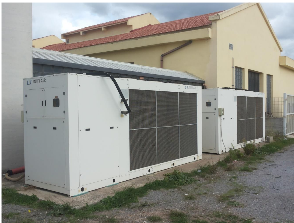
Figura 2.3.2.1. Pompe di calore.
