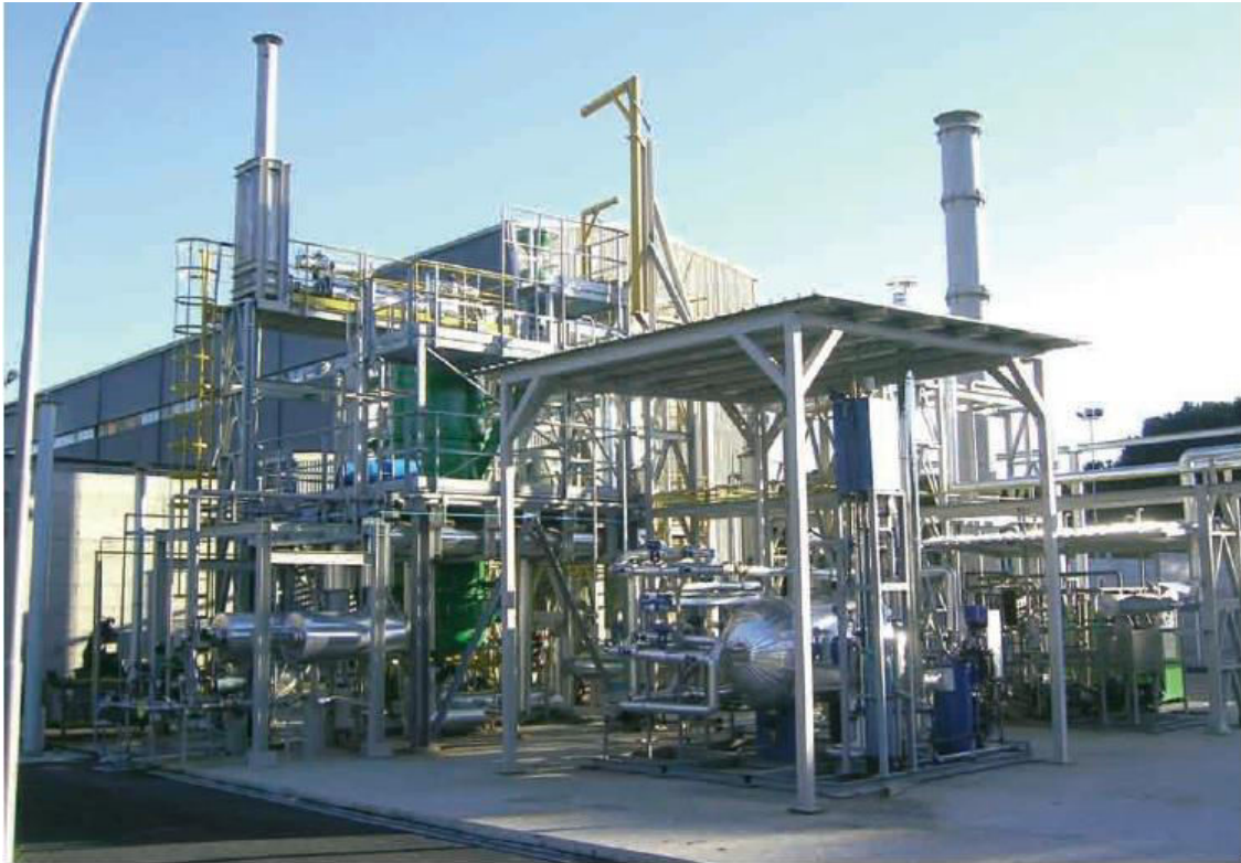
Figura 4 Piattaforma sperimentale dell'impianto ZECOMIX.
