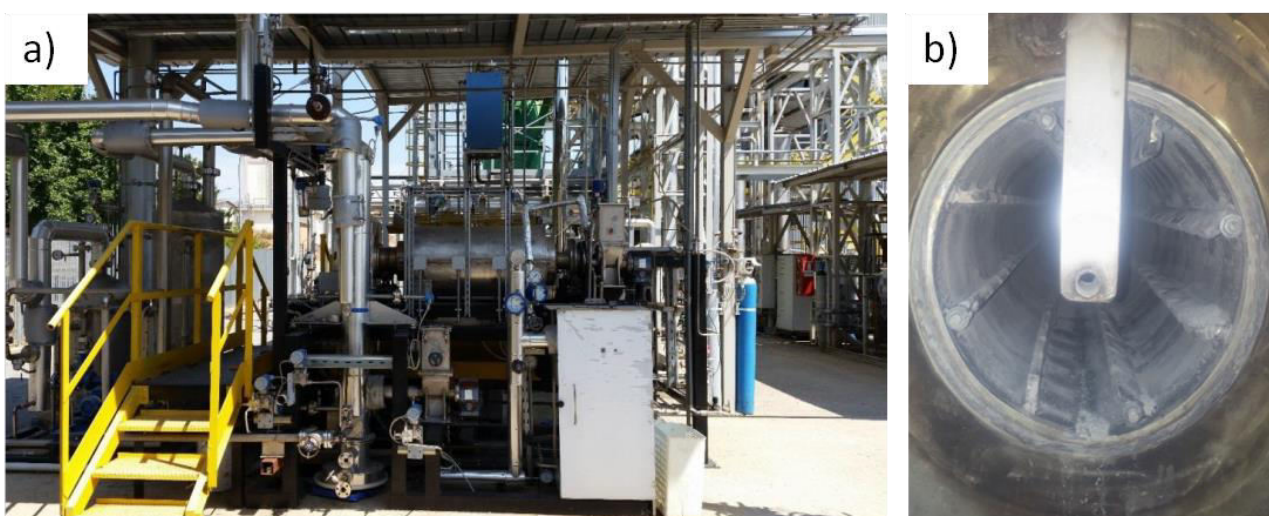
Figura 3 (a) Vista complessiva della Piattaforma Valchiria; (b) Vista interna del tamburo rotante
