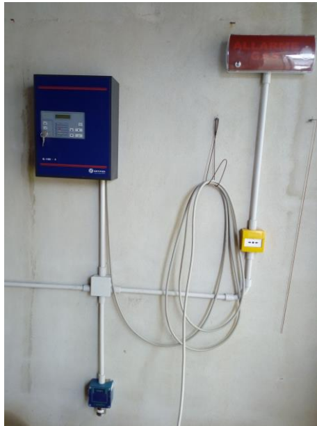
Figura 2.5. Componenti del sistema di rilevazione H2S.
