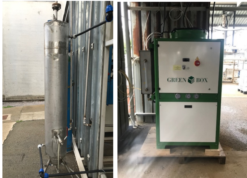
Figura 19. Separatore di condensa incamiciato (sinistra) e chiller (destra)
