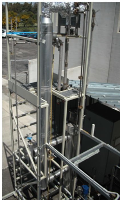
Figura 10. Unità di rigenerazione delle ammine.
