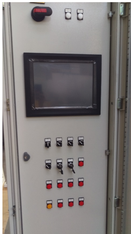
Figura 12 Quadro elettrico di controllo
