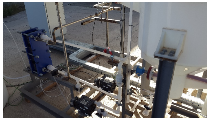
Figura 10 Scambiatore a piastre e pompe rilancio soluzione
