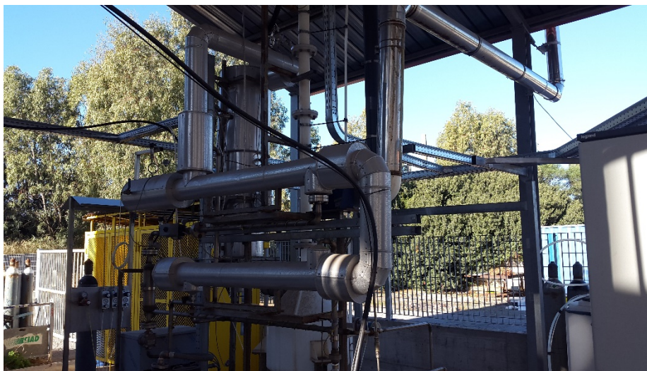
Figura 1 Vista frontale dell'impianto IOSTO
