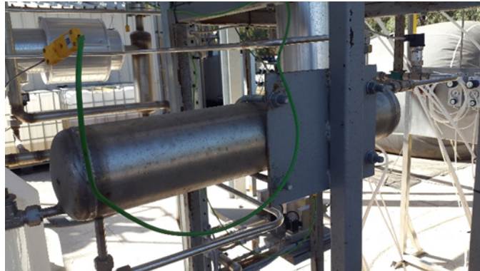
Figura 9 Scambiatore gas –liquido ingresso colonna
