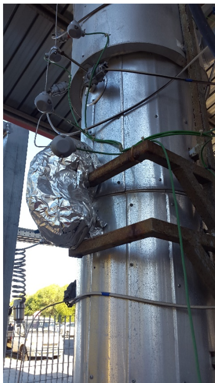
Figura 3 Coibentazione intercooler tra i due stadi del reattore
