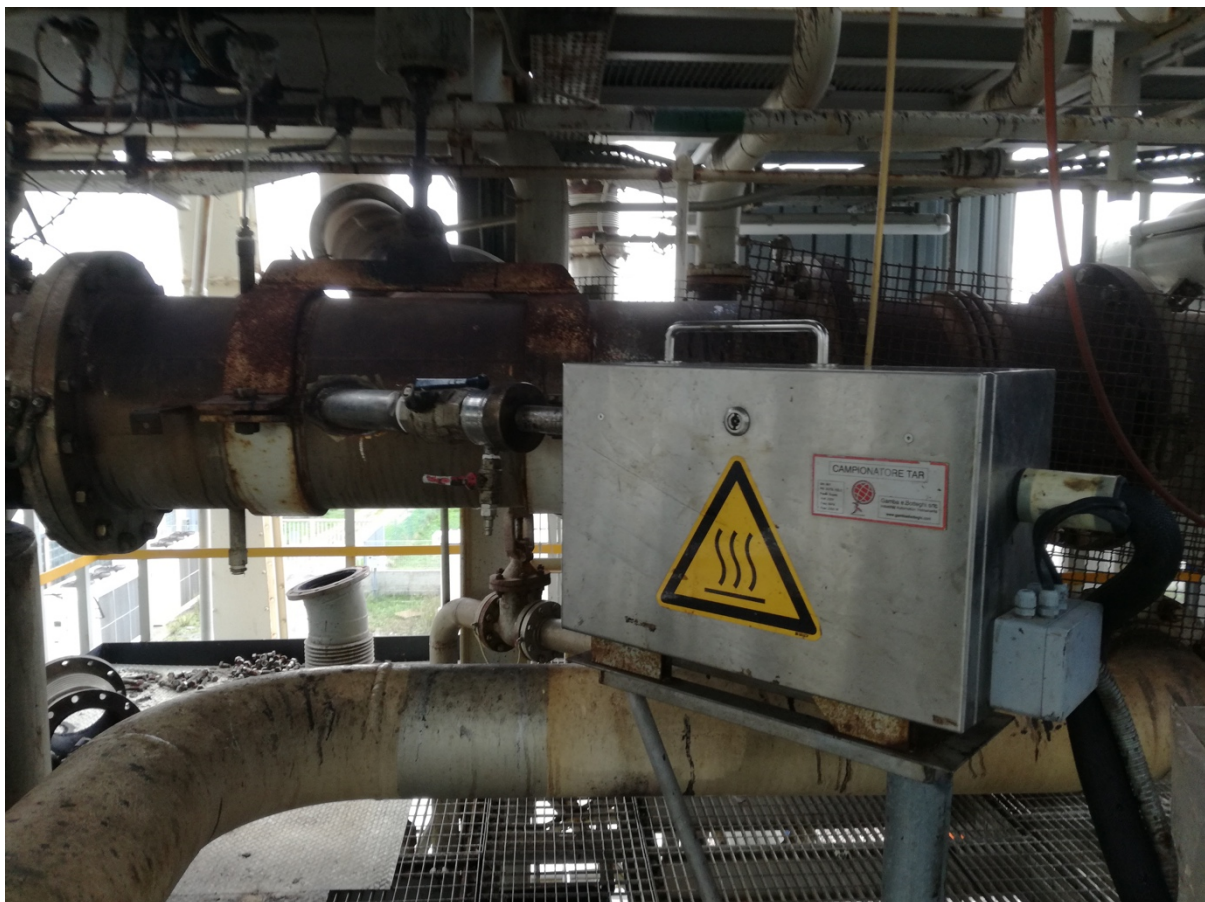
Figura 9. Nuova installazione del sistema di campionamento TAR (Gamba&Botteghi)
