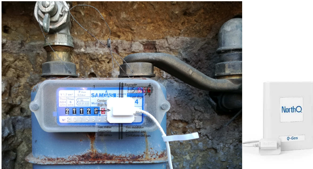
Figura 14- Installazione del North Q Gas reader presso l'abitazione 5
