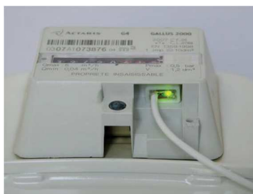
Figura 13- esempio di monitoraggio del gas su contatore magnetico
