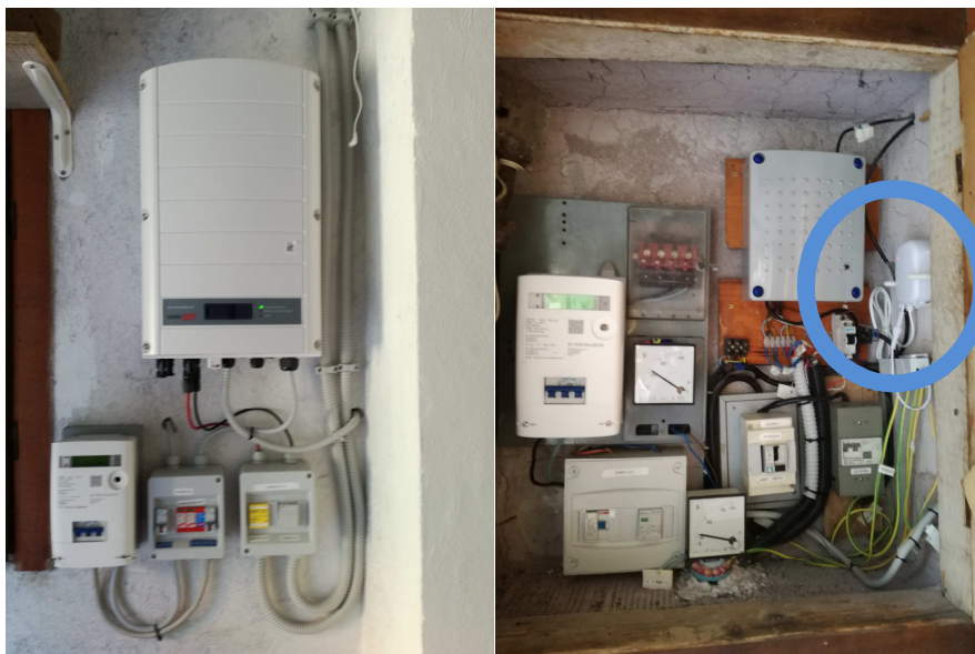
Figura 10- a) Foto inverter contatore fotovoltaico; b) foto del Meter elettrico a monte del contatore di rete
