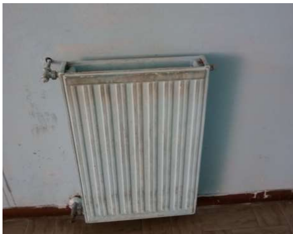
Fig.4.3.2. – Termosifoni con assenza di valvole termostate
