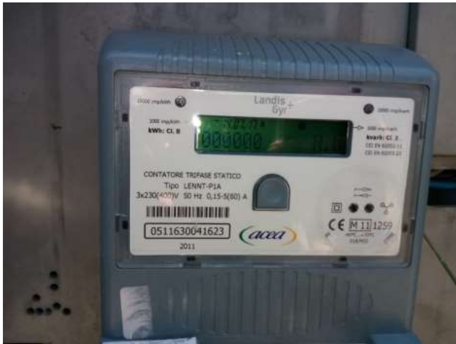
Fig.10.3.3 – Contatore energia elettrica, non funzionante
