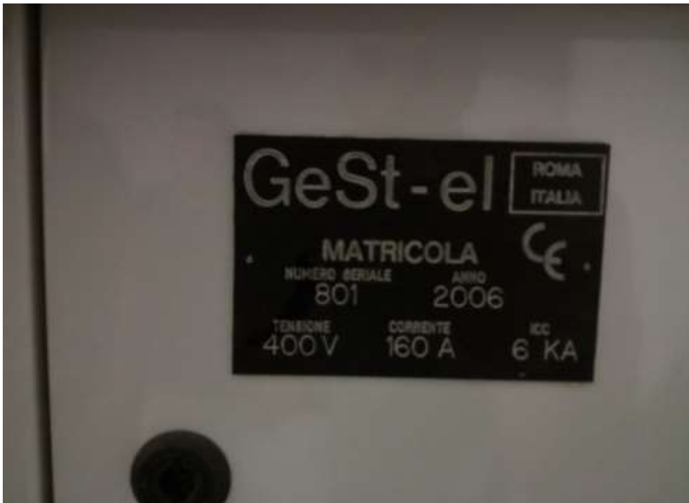
Fig.3.3.10 - Dati di targa del quadro elettrico
