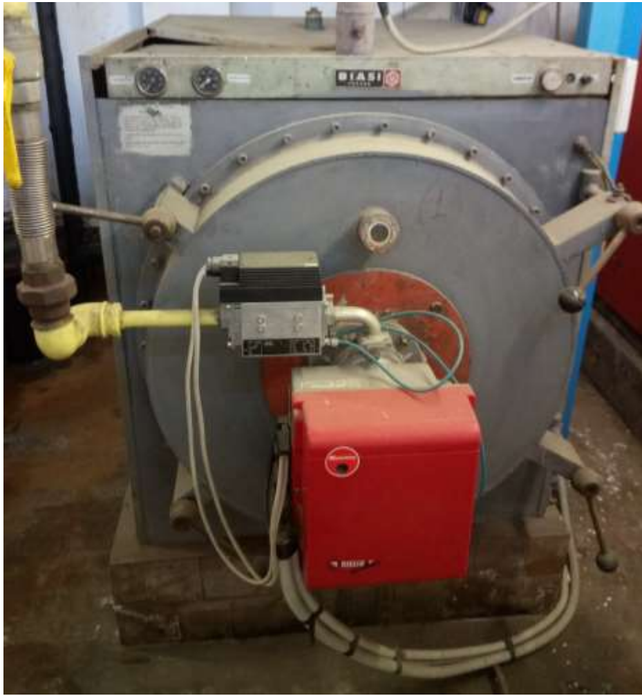
Fig.7.3.2 – Caldaia da 420 kW di potenza termica utile
