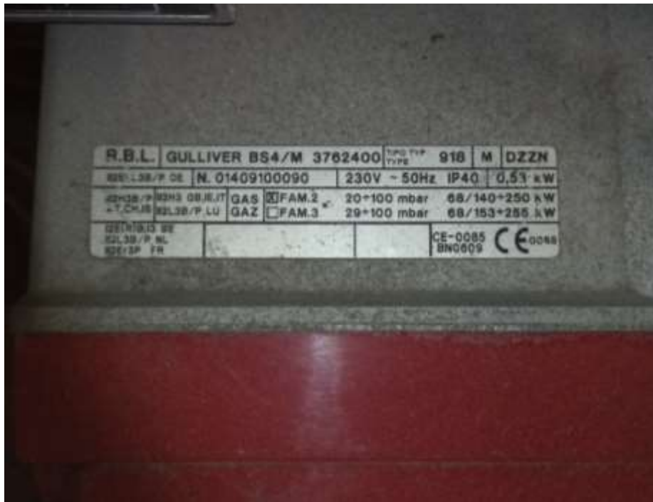
Fig.7.3.3 – Dati di targa del bruciatore relativo alla caldaia da 420 kW
