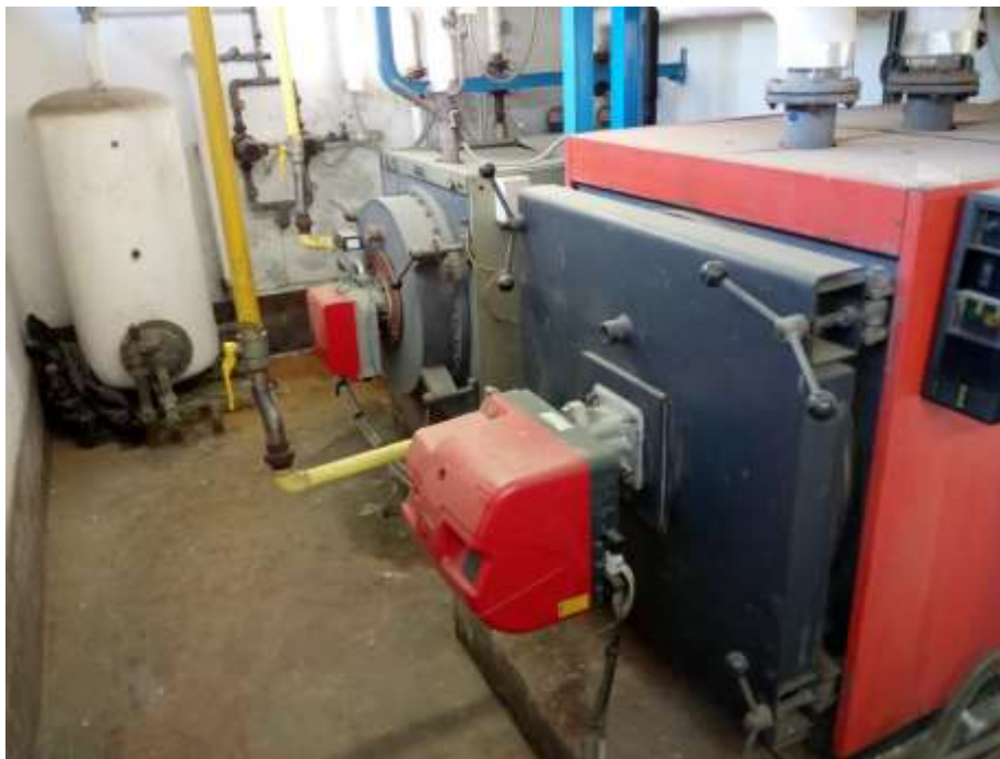
Fig.7.3.1 – Locale termico, caldaie
