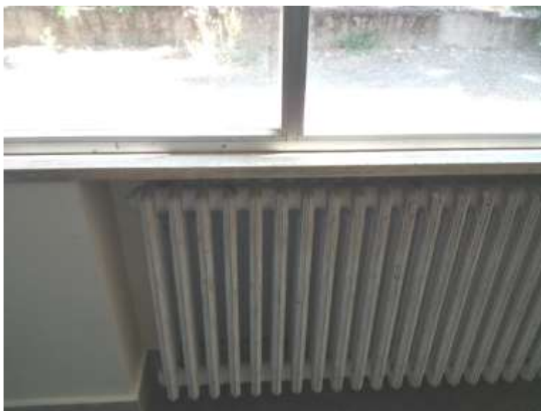
Fig.7.3.7 – Termosifone aula, assenza di valvole termostate
