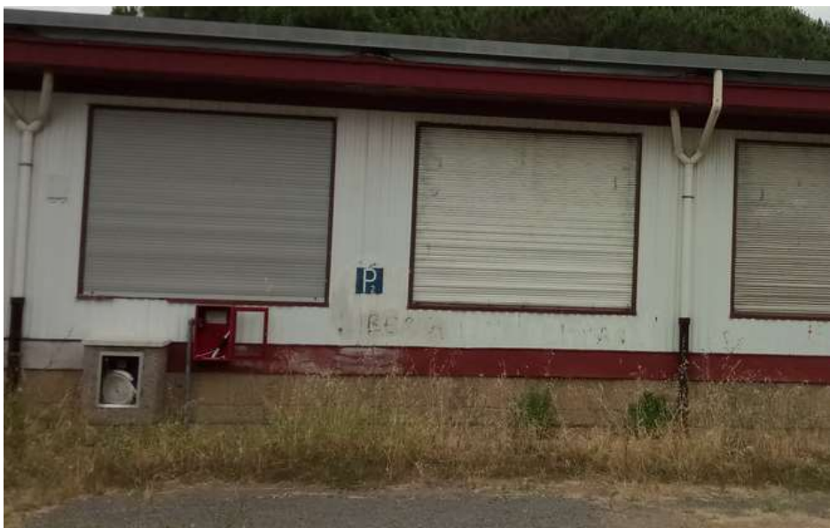
Fig.5.2.6 – Schermatura esterna, avvolgibili in PVC
