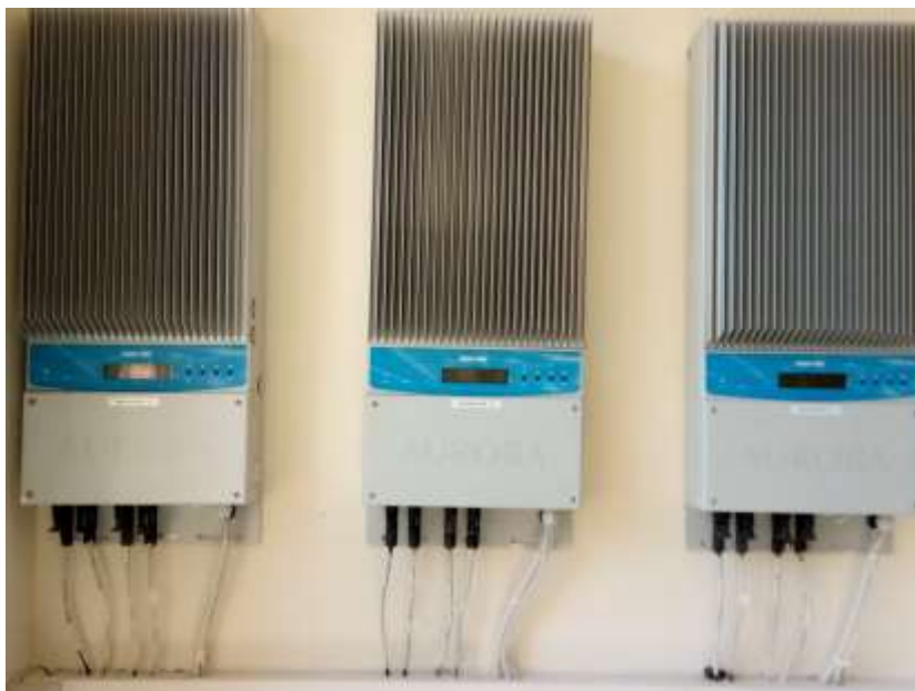
Fig.4.3.6 – Inverter impianto fotovoltaico
