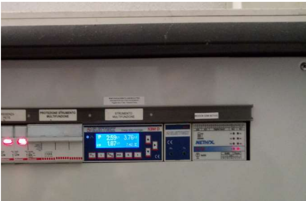
Fig.3.3.11 – Misuratore generale di energia della palazzina A
