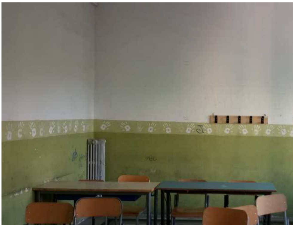
Fig.3.3.7 - Termosifone aule, assenza di valvole termostate
