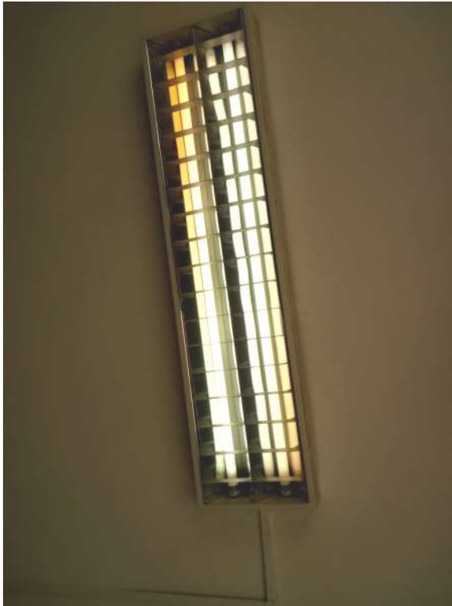
Fig.9.3.3 – Tipologia di lampade installate
