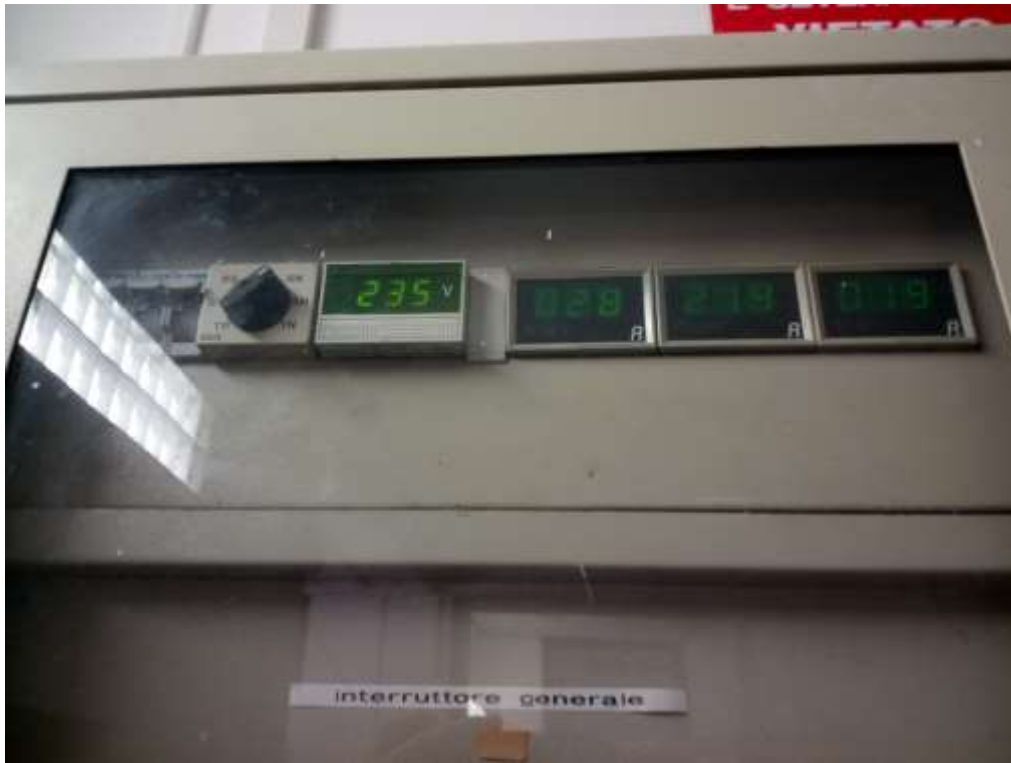
Fig.4.3.3. – Misuratori di corrente e tensione del quadro generale
