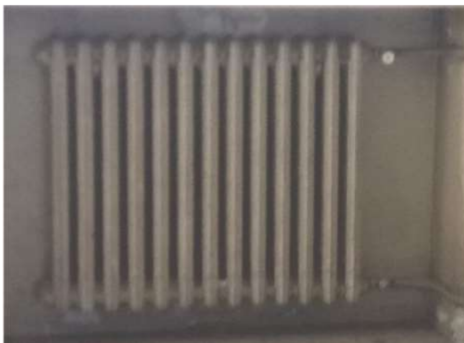
Fig.8.3.1 – Termosifoni d’aula con l’assenza di valvole termostatate
