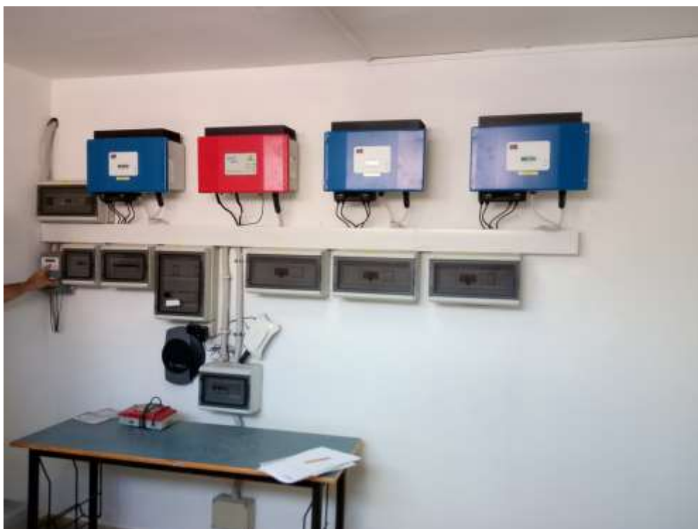
Fig.9.3.5 – Inverter e quadri relativi all'impianto fotovoltaico
