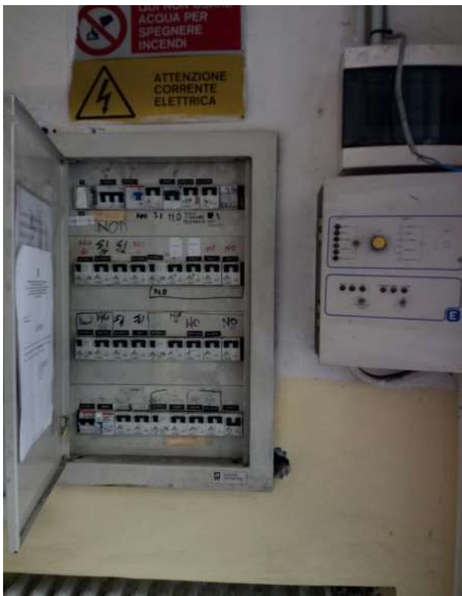
Fig.6.3.3 – Quadro elettrico di piano
