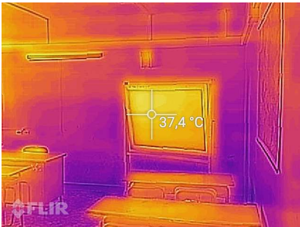
Fig.11.2.7 – Termofoto delle aule dell'ultimo piano
