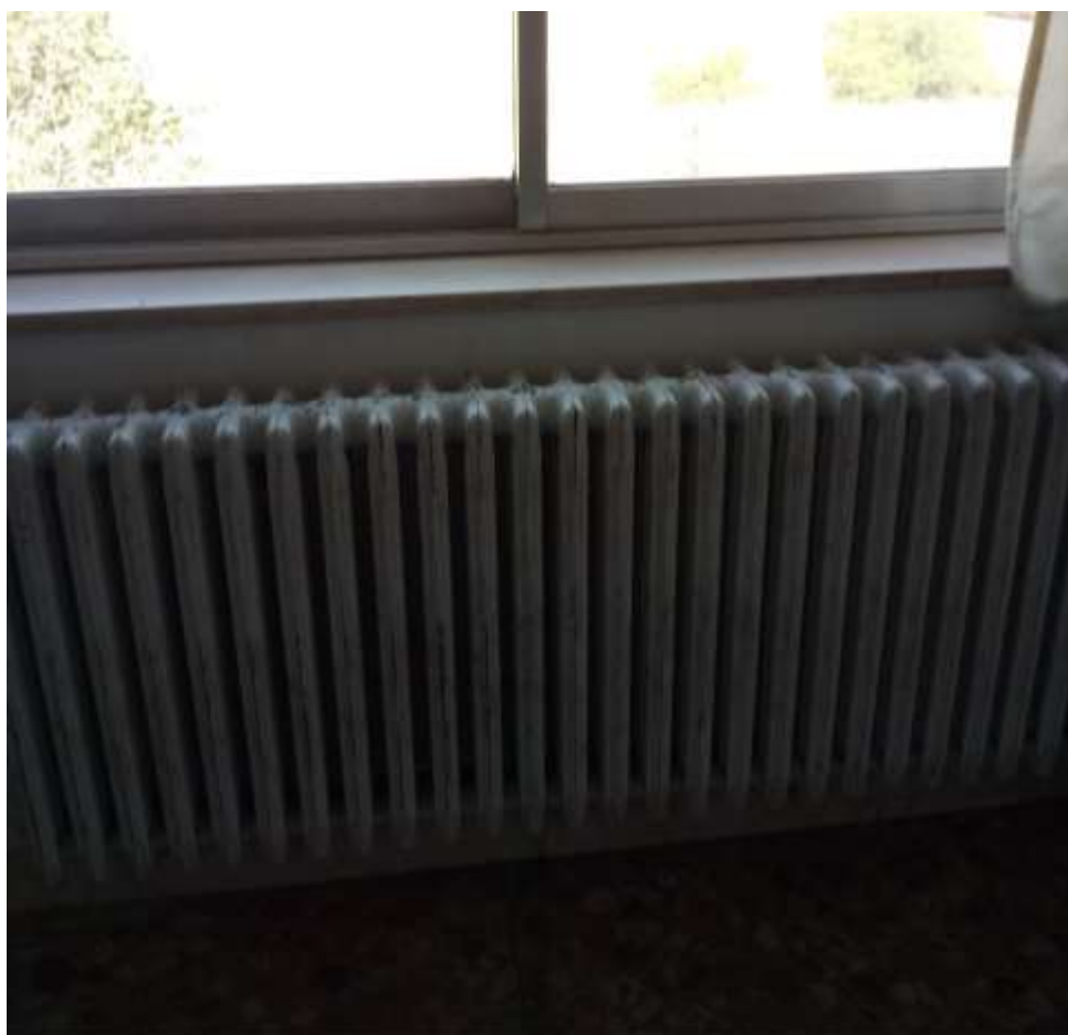
Fig.11.3.2 – Termosifone d'aula, assenza di valvole termostate
