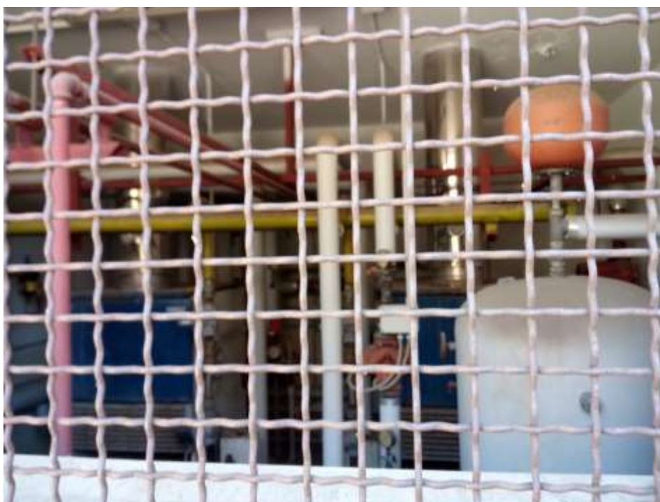
Fig.4.3.1. – Vista esterna della centrale termica
