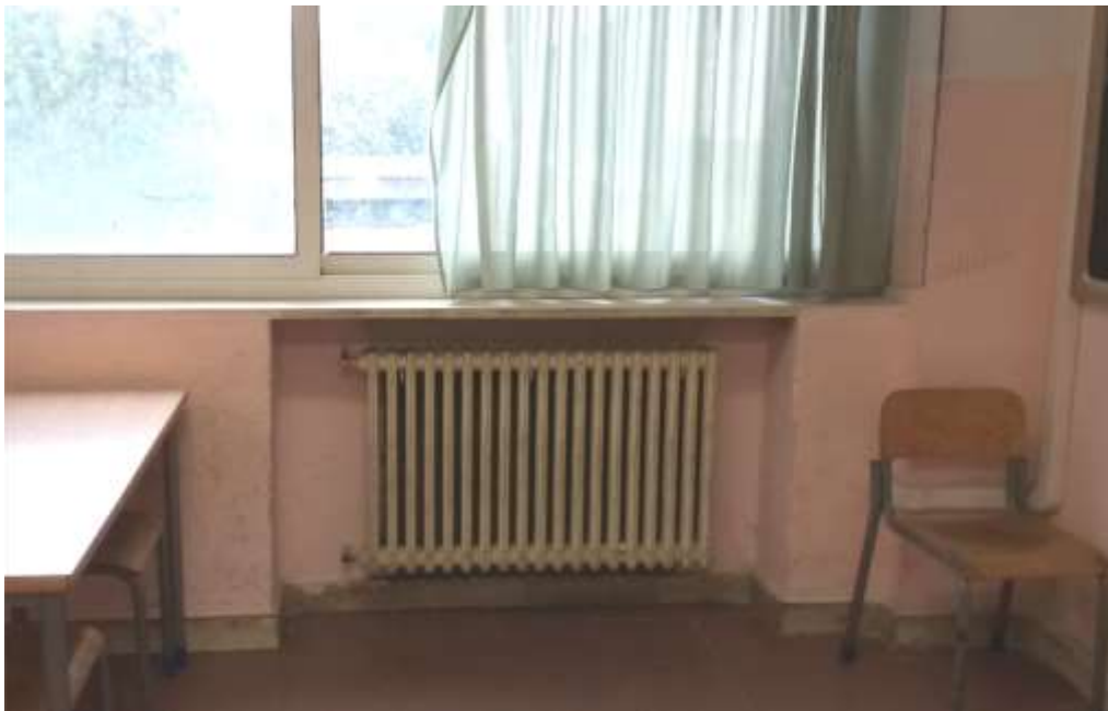
Fig.6.3.1 – Termosifoni in ghisa, assenza di valvole termostate
