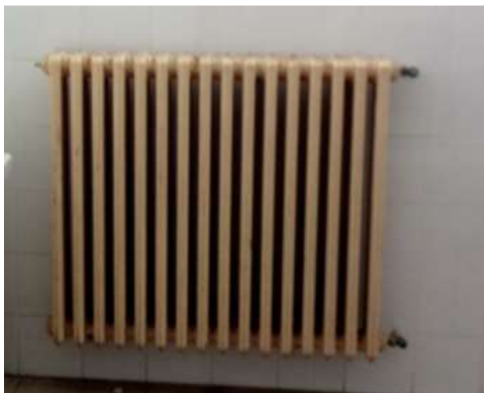
Fig.9.2.2 – Termosifone, assenza di valvole termostate
