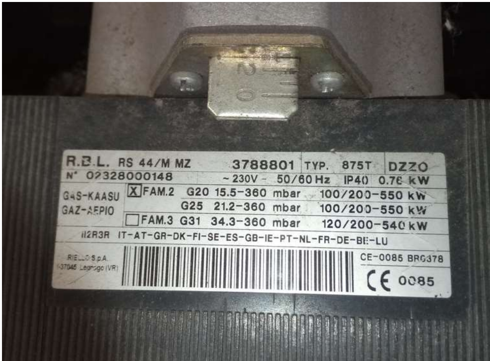
Fig.7.3.5 – Dati di targa del bruciatore relativo alla caldaia da 550 kW
