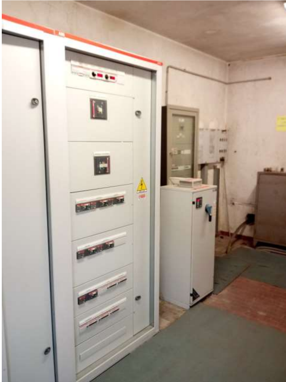
Fig.5.3.8 – Quadro elettrico generale, a destra è presente un rifasatore di carico
