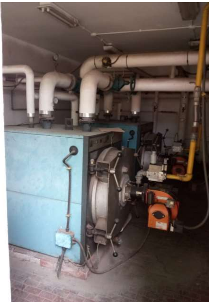
Fig.5.3.3 – Caldaie da 250 kW ciascuna
