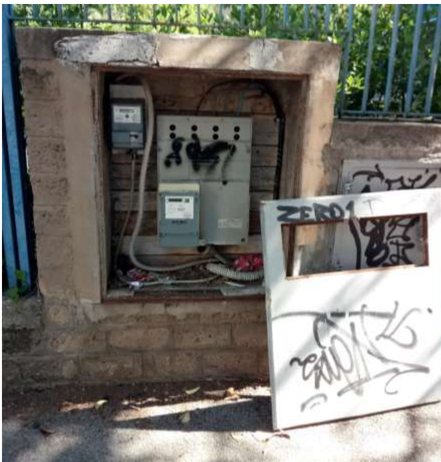
Fig.7.3.8 – Contatori energia elettrica
