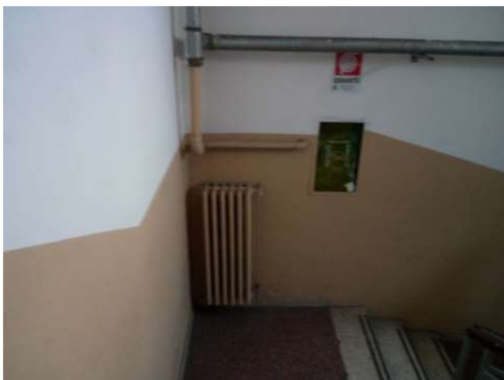
Fig.3.3.8 - Termosifone corridoio verniciato, assenza di valvole termostate
