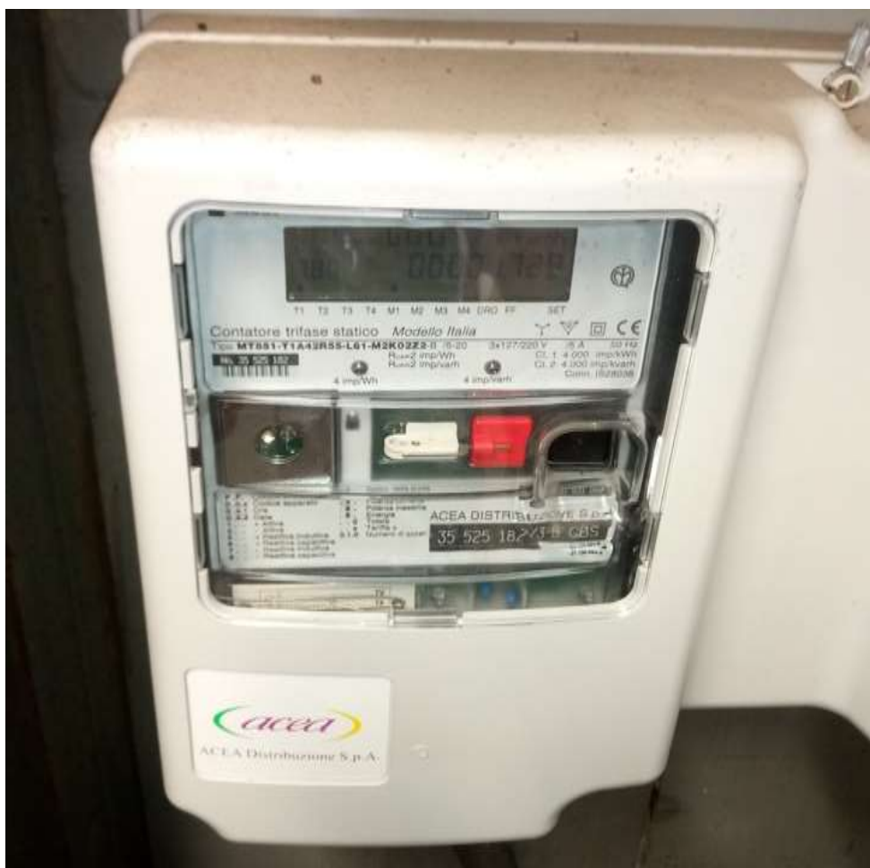
Fig.5.3.9 – Contatore energia elettrica
