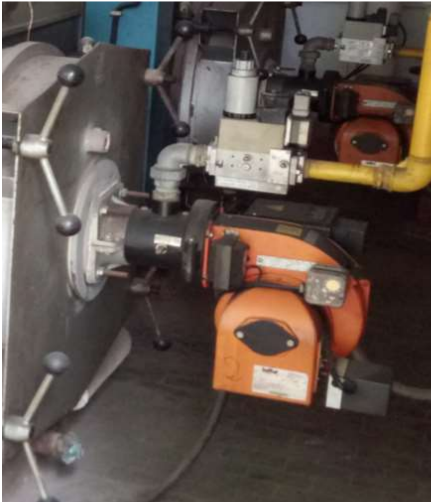
Fig.5.3.4 – Bruciatori da 338 kW ciascuno
