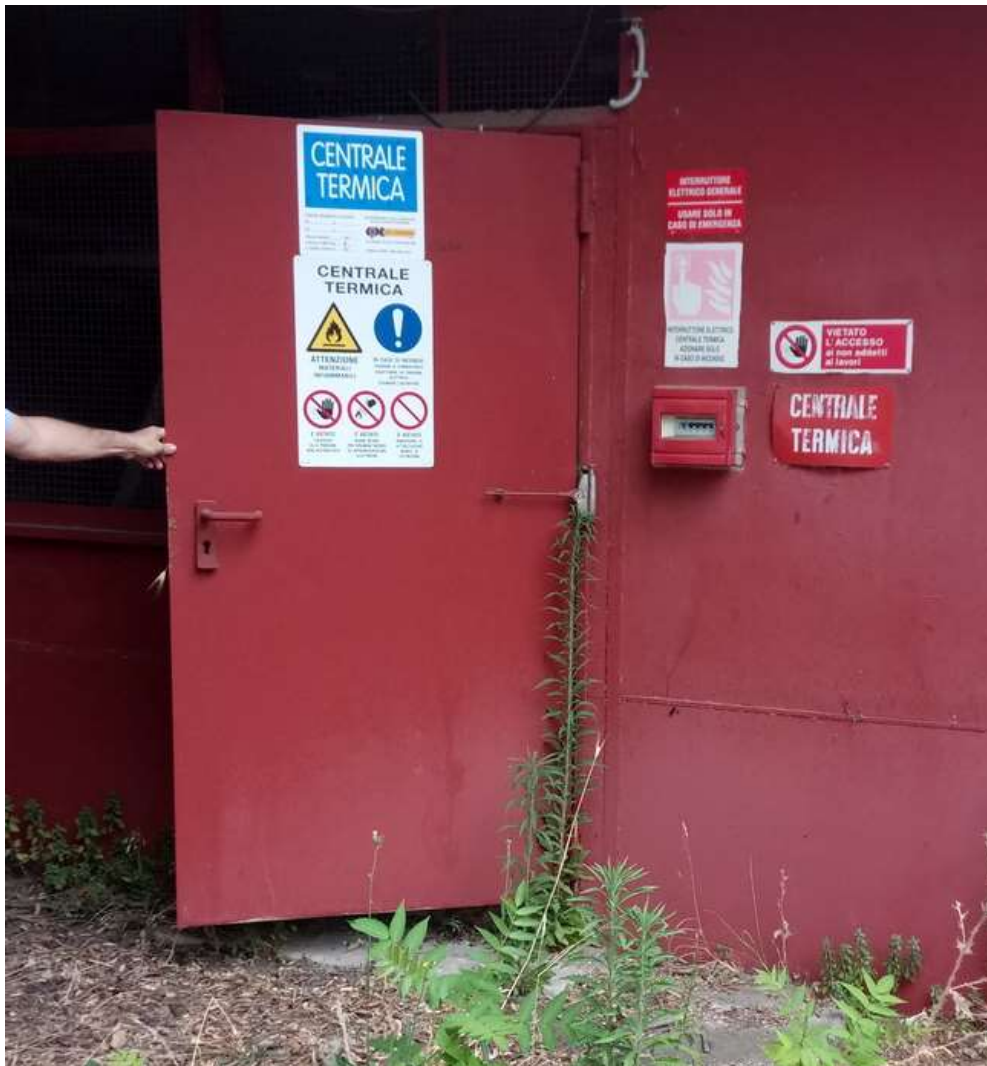
Fig.5.3.2 – Centrale con la porta rotta
