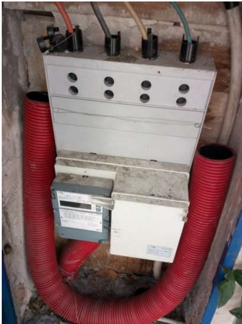
Fig.13.3.1 – Contatore energia elettrica
