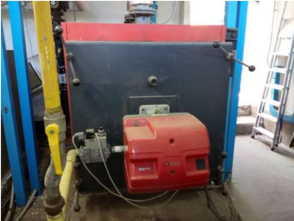
Fig.7.3.4 – Caldaia da 550 kW di potenza termica massima
