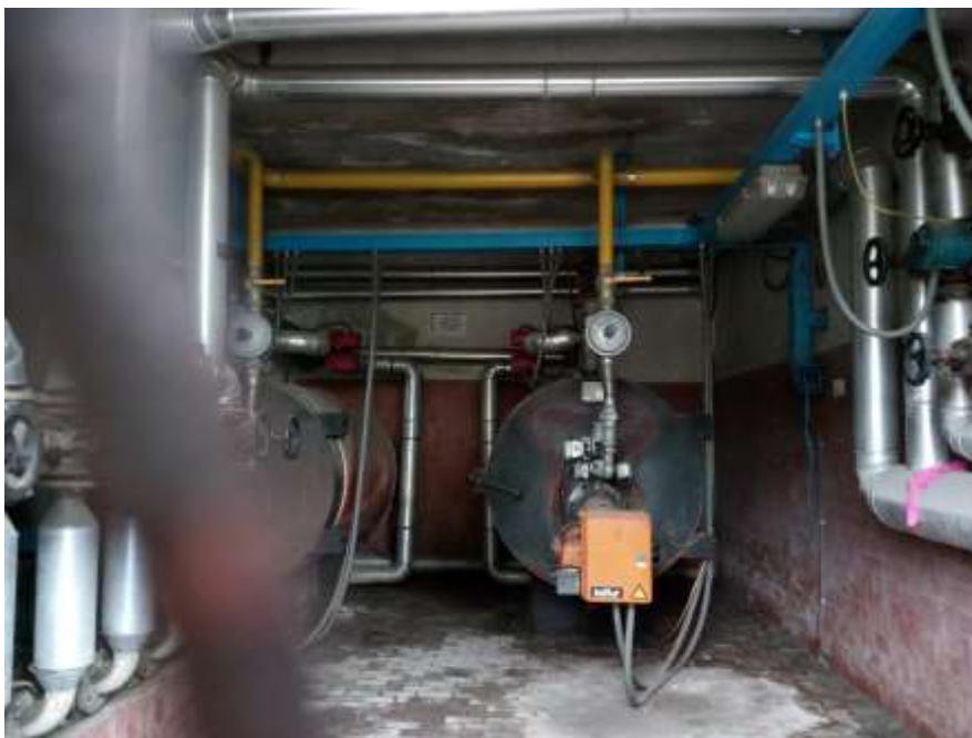
Fig.5.3.5 – Caldaie di una centrale non accessibile
