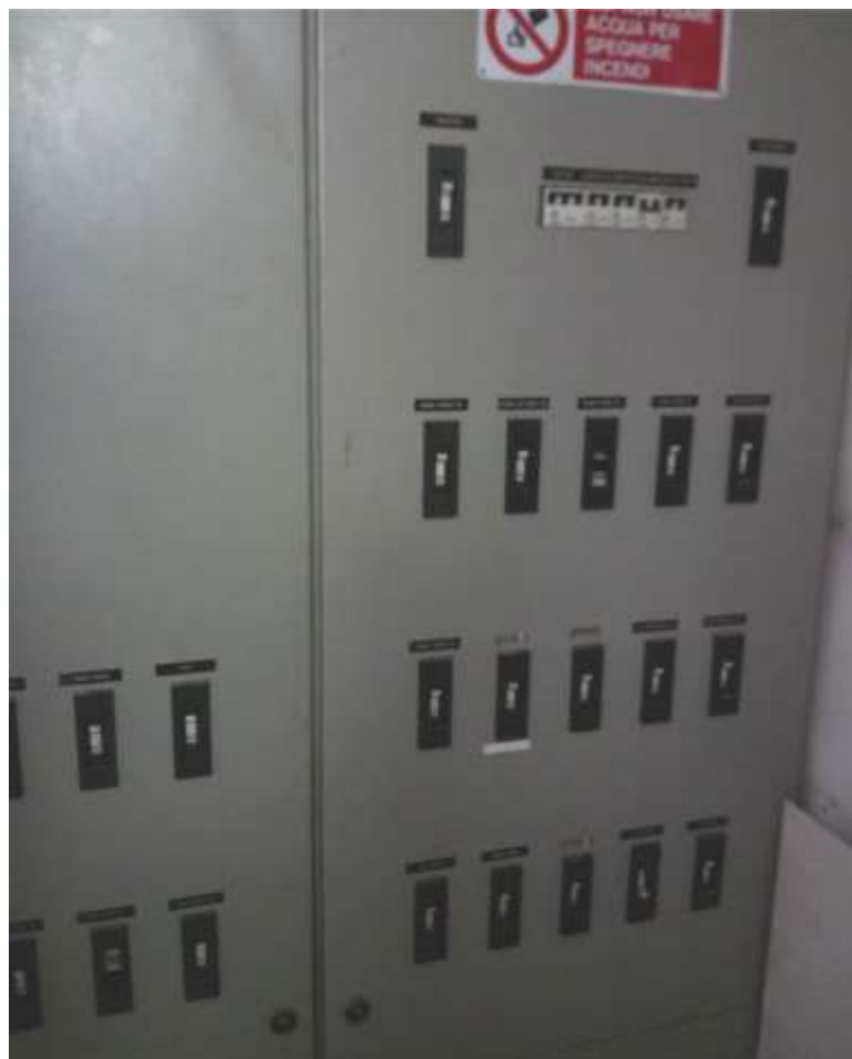
Fig.6.3.2 – Quadro elettrico generale
