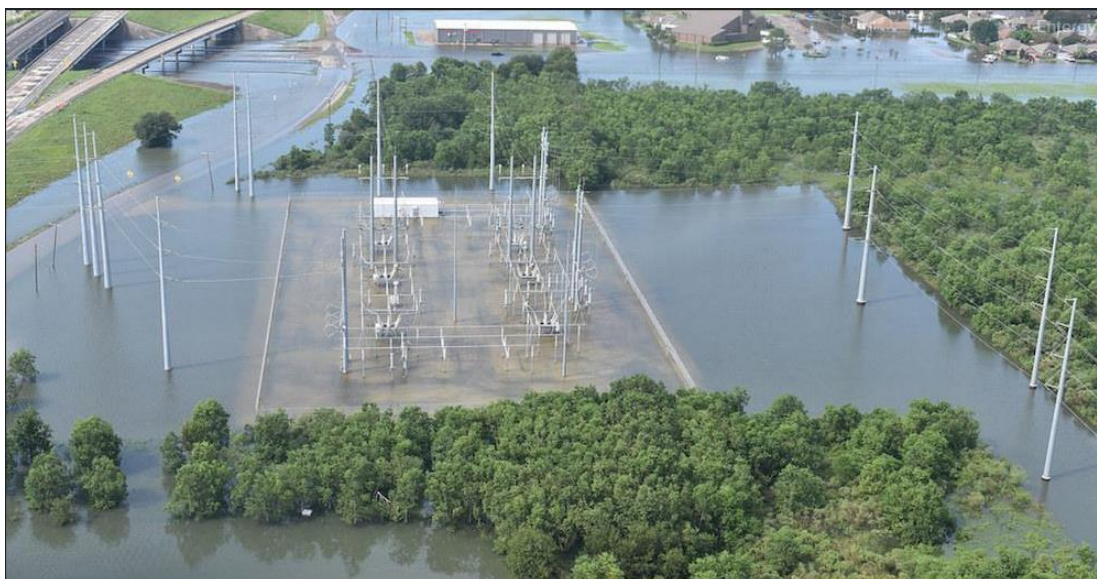
Figura 9 Allagamento delle infrastrutture di Entergy provocato dall'uragano Harvey in Texas nel 2017 da http://www.tdworld.com/
