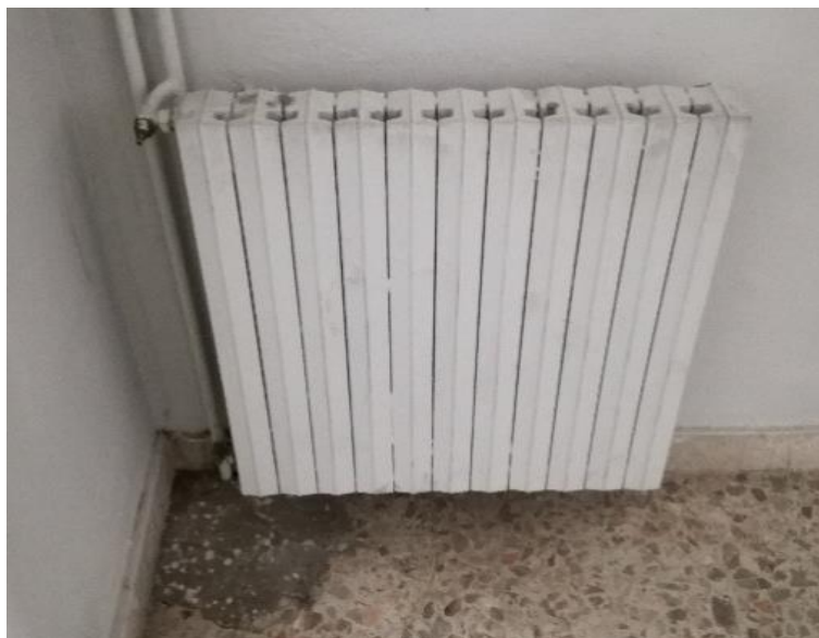
Fig. 3.2.5 - Termosifone verniciato a più strati dotato di rubinetto bloccato e con perdita
