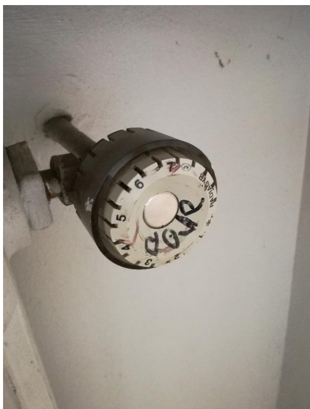
Fig.3.8.3 - Manopola termostata datata e fuori uso
