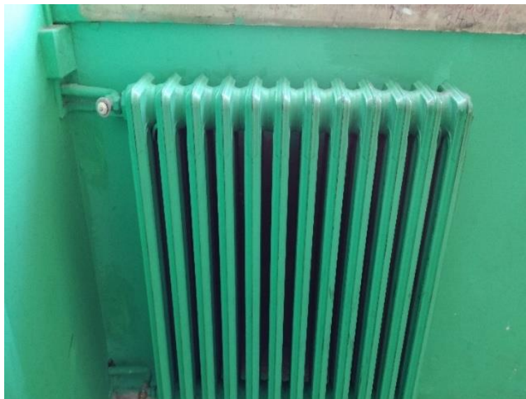
Fig.3.11.3 - Termosifone in ghisa con manopola termostata rotta
