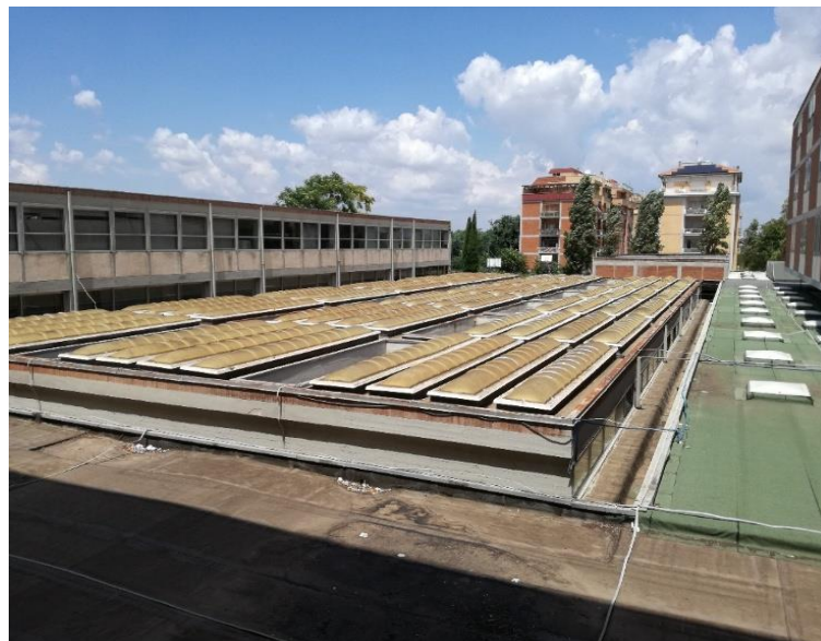
Fig.3.5.2 - Copertura dei laboratori mediante lucernai senza controllo radiazione solare
