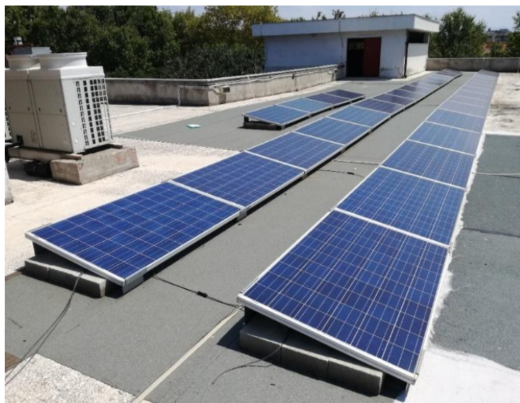
Fig.3.7.4 - Impianto fotovoltaico composto da pannelli fissati con inclinazione non ottimizzata
