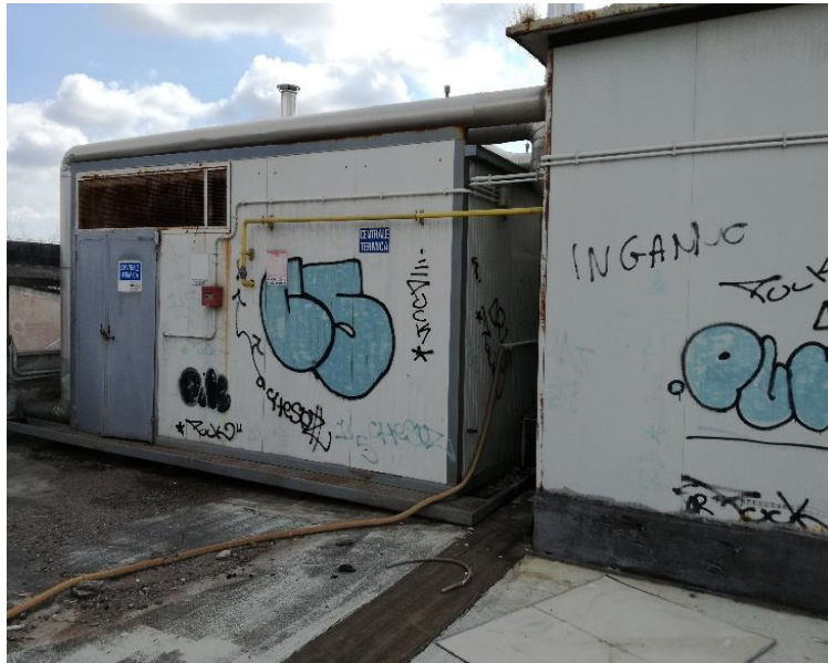
Fig.3.4.7 - Centrale termica installata in copertura e non accessibile
