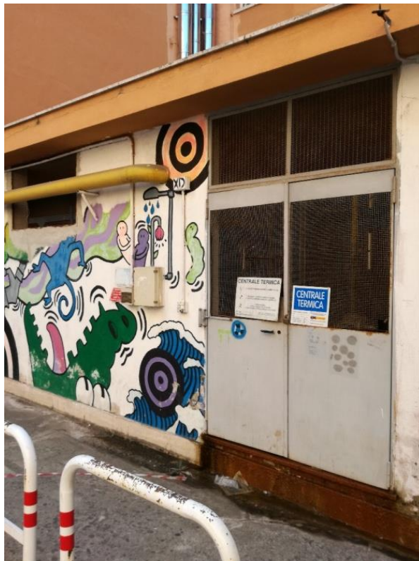
Fig. 3.1.5 - Centrale termica, chiusa a chiave, con perdita d'acqua e ruggine su tutte le parti metalliche
