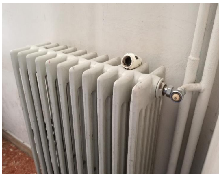
Fig.3.7.2 - Manopola termostata rotta e abbandonata sul termosifone
