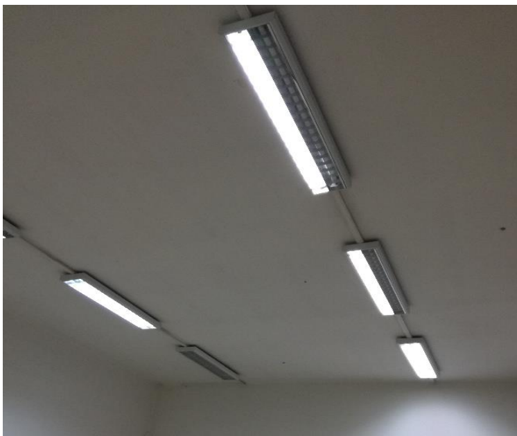
Fig. 3.1.2 - Lampade fluorescenti datate e talvolta parzialmente funzionanti
