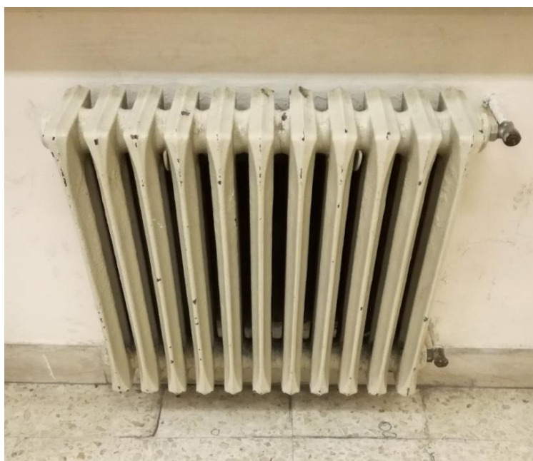
Fig. 3.1.3 – Termosifone in ghisa verniciato con rubinetto rotto
