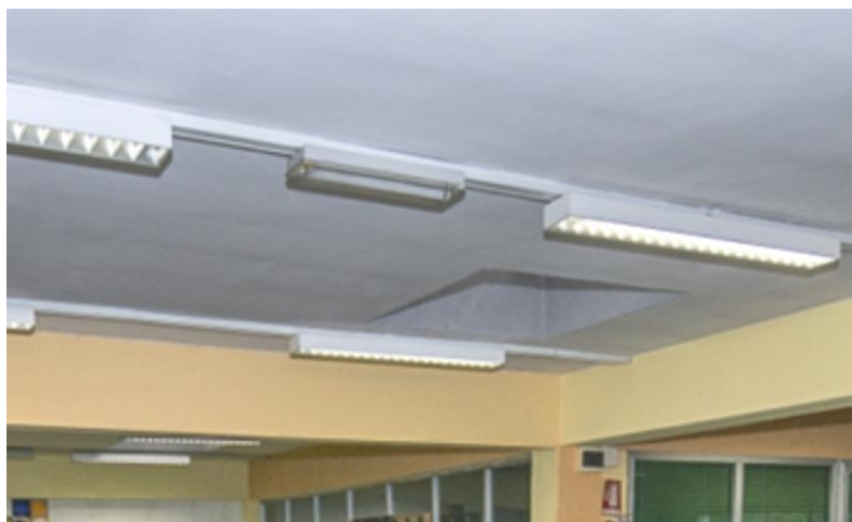
Fig.3.13.1 – Plafoniere con lampade fluorescenti
