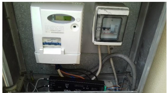
Figura 3 – Arrangiamento della nuova cabina elettrica: in basso è visibile il concentratore
