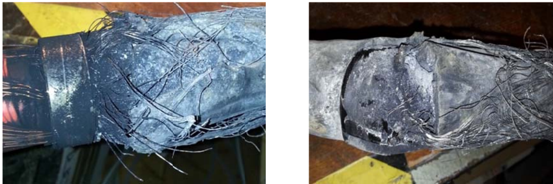
Figura 8. Esempi di giunti e cavi sotterranei danneggiati, potenzialmente per surriscaldamento.
