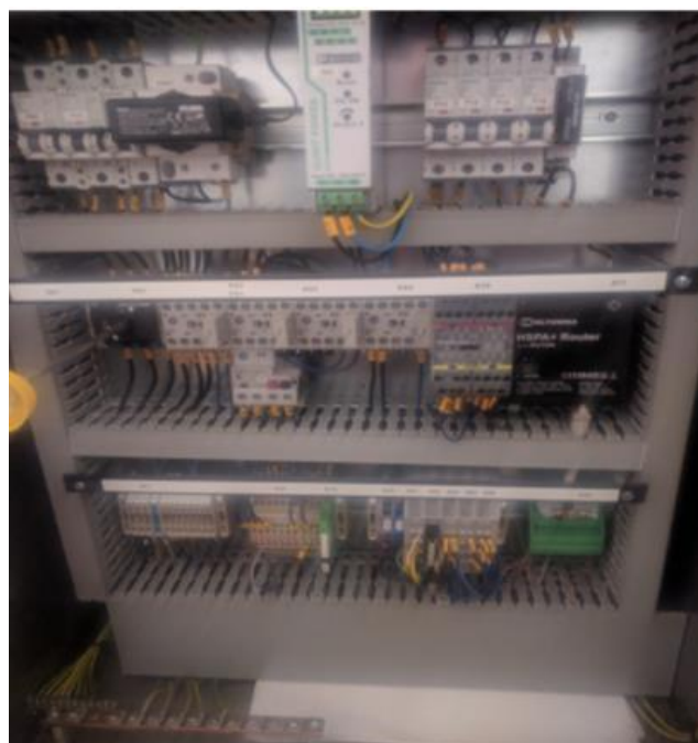
Figura 122: Quadro elettrico del compostatore Big Hanna
