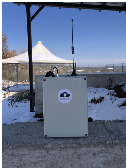
Figura 16. Particolare del sistema ricevente modem/router con antenna
