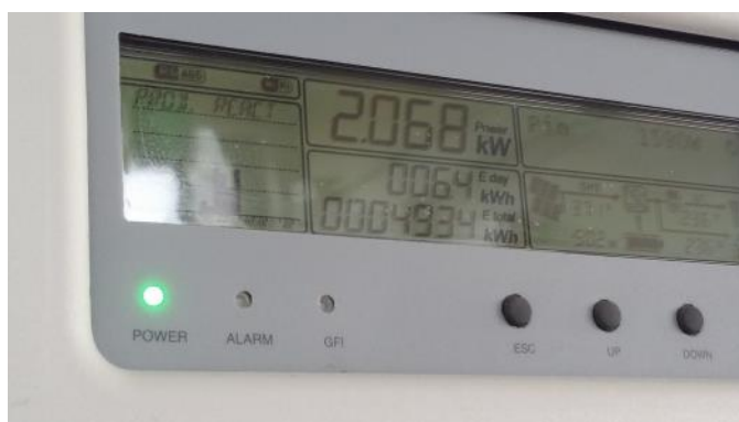
Figura 43. REACT3 con batteria in scarica P discharge = 502W
