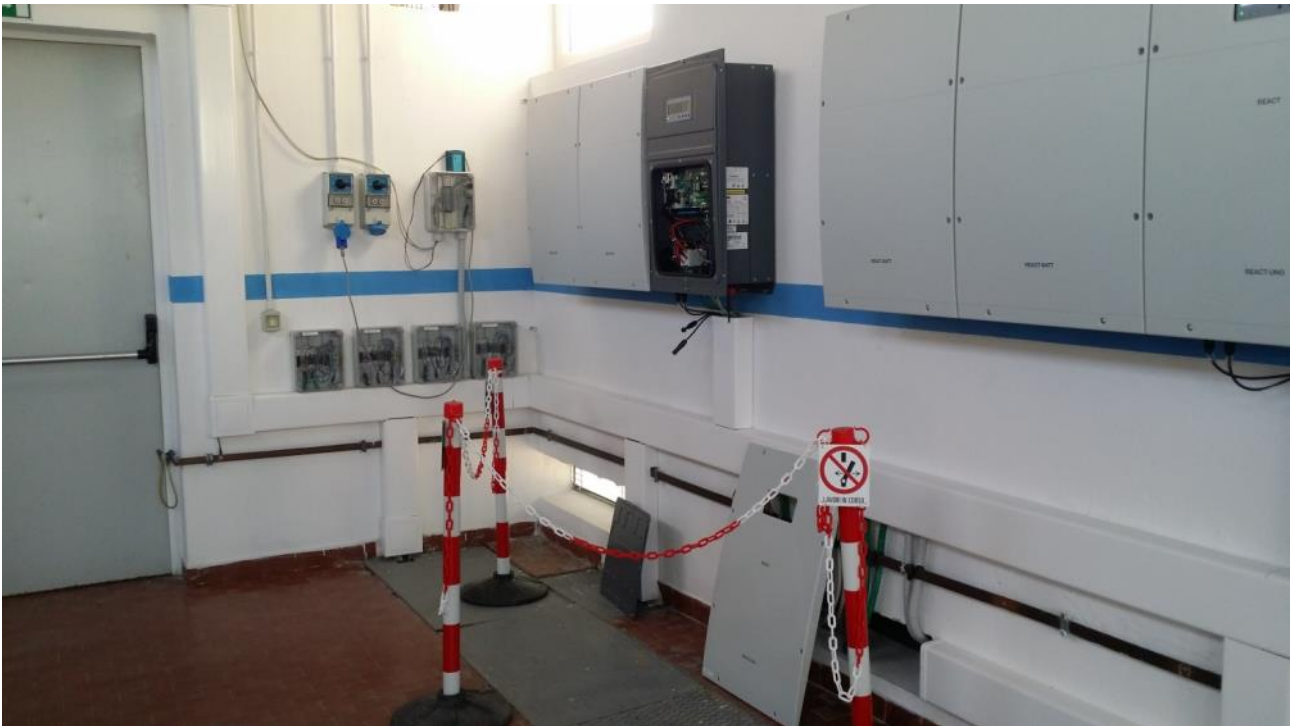
Figura 38: Il Laboratorio Campo Fotovoltaico durante i test dei protocolli di misura e controllo.
