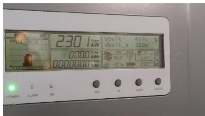
Figura 41. REACT1 con batteria in scarica P discharge = 1000W
