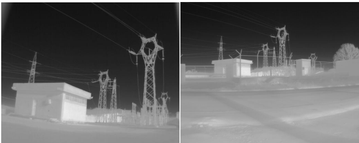
Figura 2. Due immagini termiche della sottostazione elettrica monitorata
