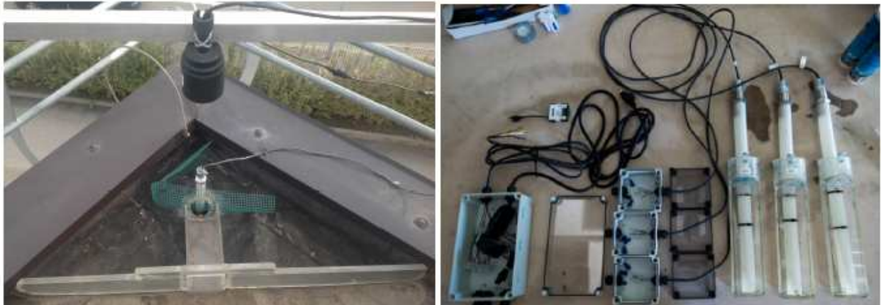
Figura 3.8: misuratori di livello installati sulla copertura sperimentale presso la sede di Ingegneria di Bologna
