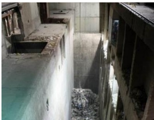
Figura 2.3 – Fossa di stoccaggio
