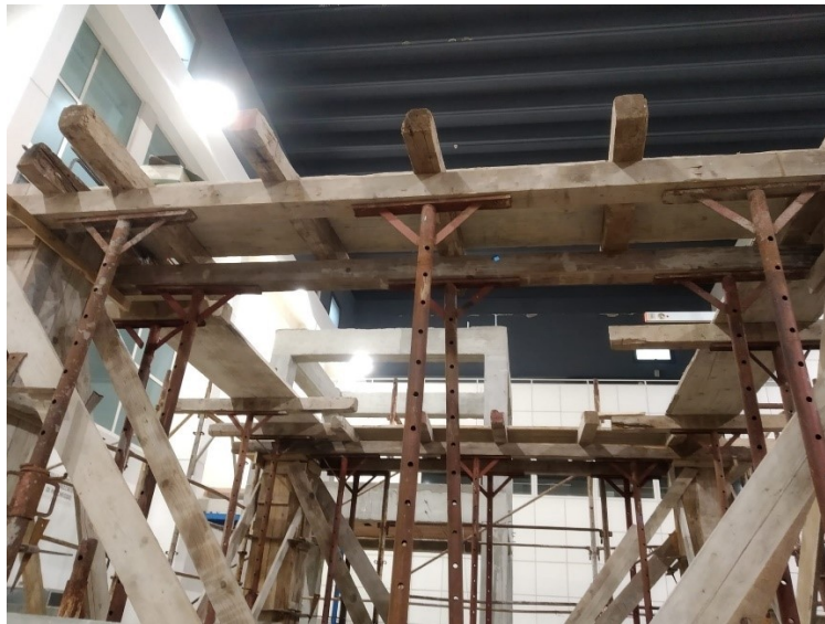
Figura 239. Realizzazione dei pilastri e del solaio: vista dei casseri della trave in spessore
