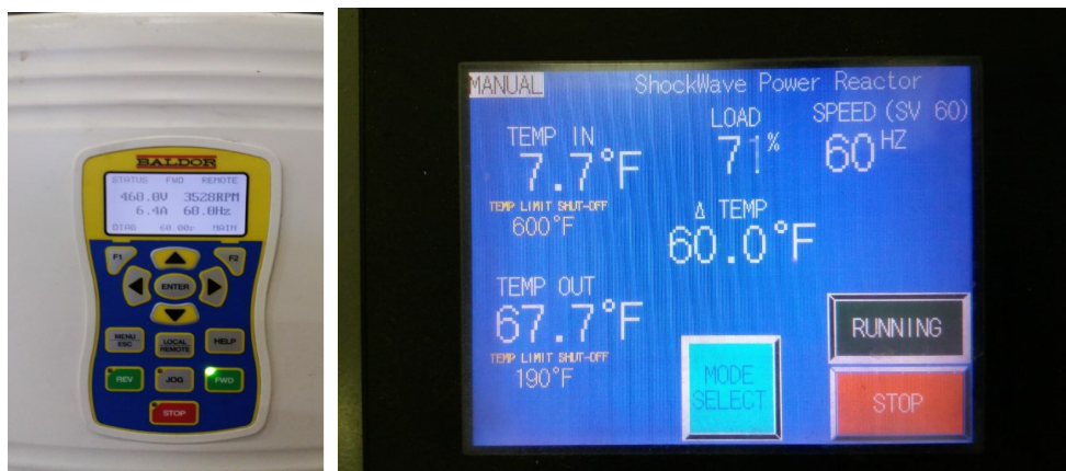
Figura 139 - Inverter (a sinistra) e Quadro di controllo (a destra) del dispositivo di cavitazione idrodinamica controllata.
