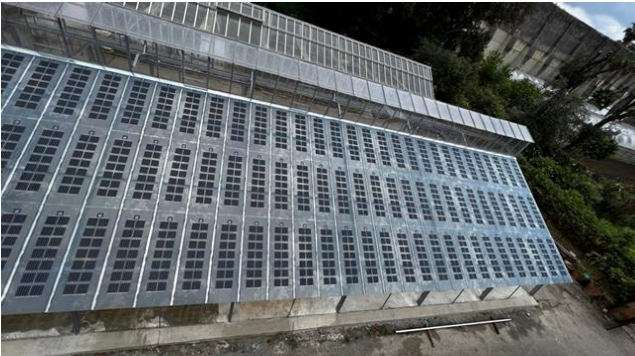
Figura 2.2.8. L'esterno della falda fotovoltaica.
