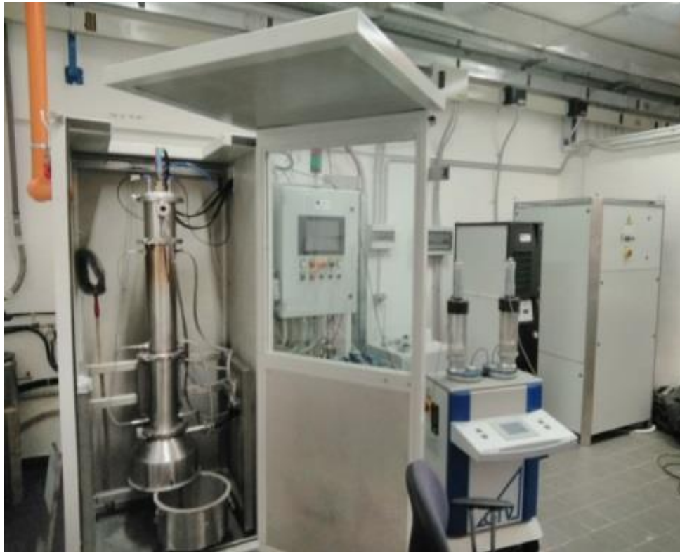
Figura 9. Impianto prototipo DC plasma installato presso CR ENEA Portici
