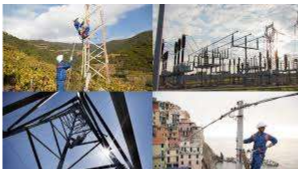
Figura 11: Infrastruttura elettrica ( www.e-distribuzione.it )
