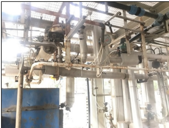
Figura 4.63 - Sistema di tubazioni a monte del BI001
