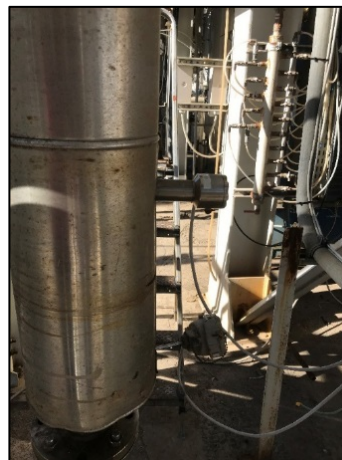
Figura 4.40 – Tubo di alimentazione agenti gassificanti riposizionato verticalmente.
