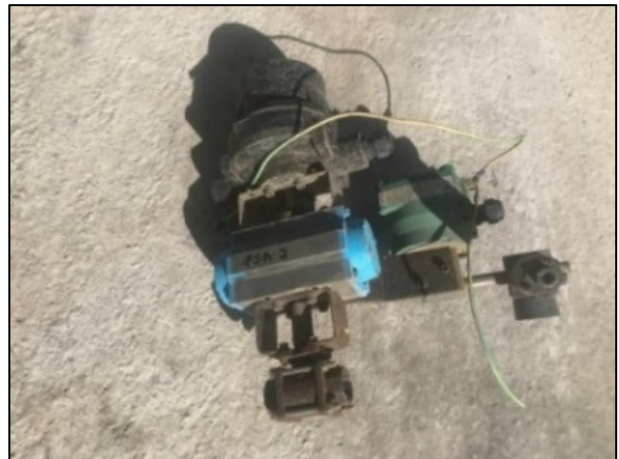
Figura 4.46 – Valvola di intercettazione FU132.
