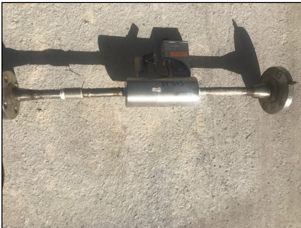
Figura 4.30 – Il regolatore massico FT502 dopo la rimozione.
