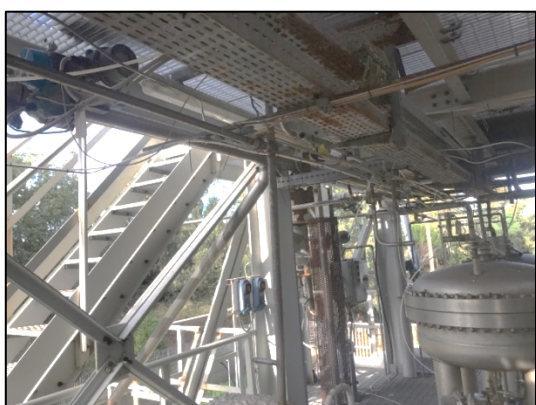
Figura 4.60 - Tubi di collegamento BA003 e reattore.
