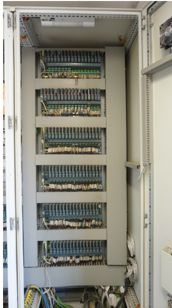
Figura 3.1 – Quadro sistema di controllo.
