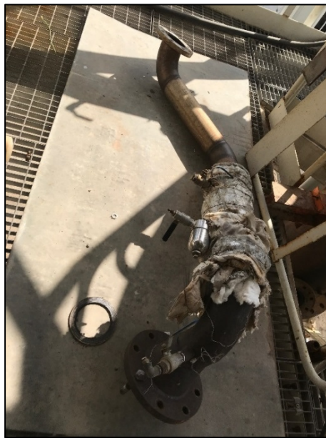
Figura 4.16 - Tubazione di uscita syngas rimossa.
