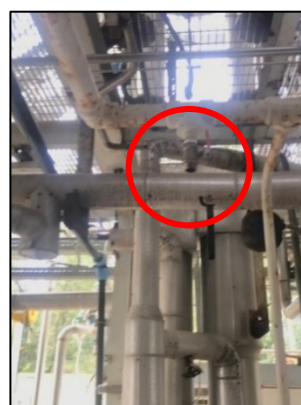
Figura 4.61 - Piping di adduzione acqua dopo l'eliminazione dello stacco allo scambiatore
