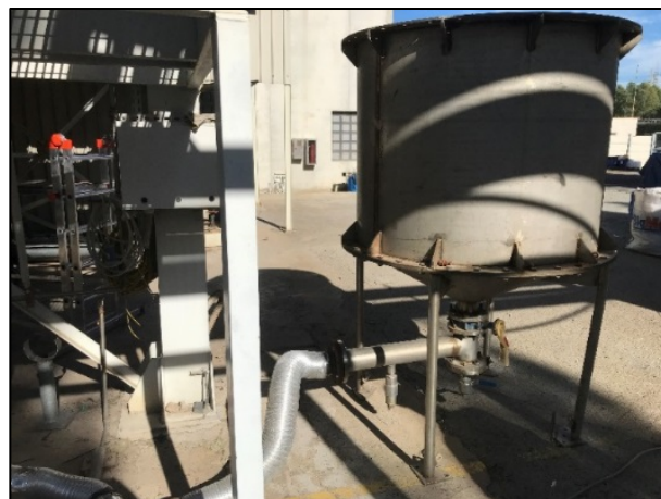
Figura 4.42 – Essiccatore a torre, ricollegato al riscaldatore dopo il riposizionamento.
