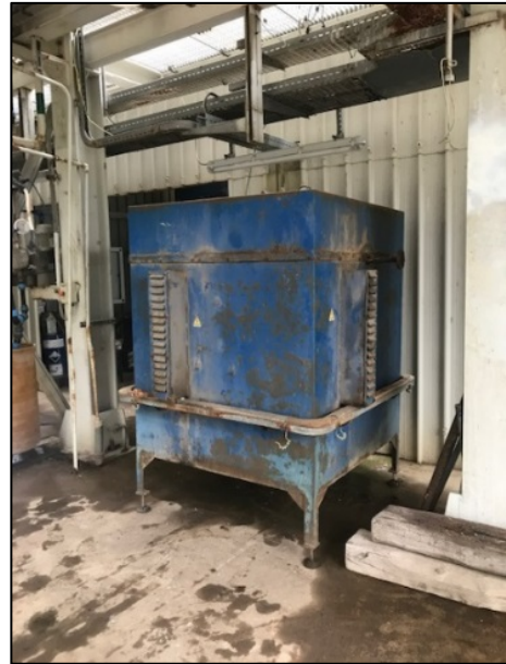
Figura 4.66 - Riscaldatore al termine di disinstallazione e riposizionamento.
