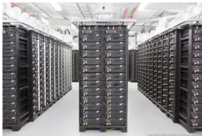
Figura 8 – Sistema di accumulo Second Life
