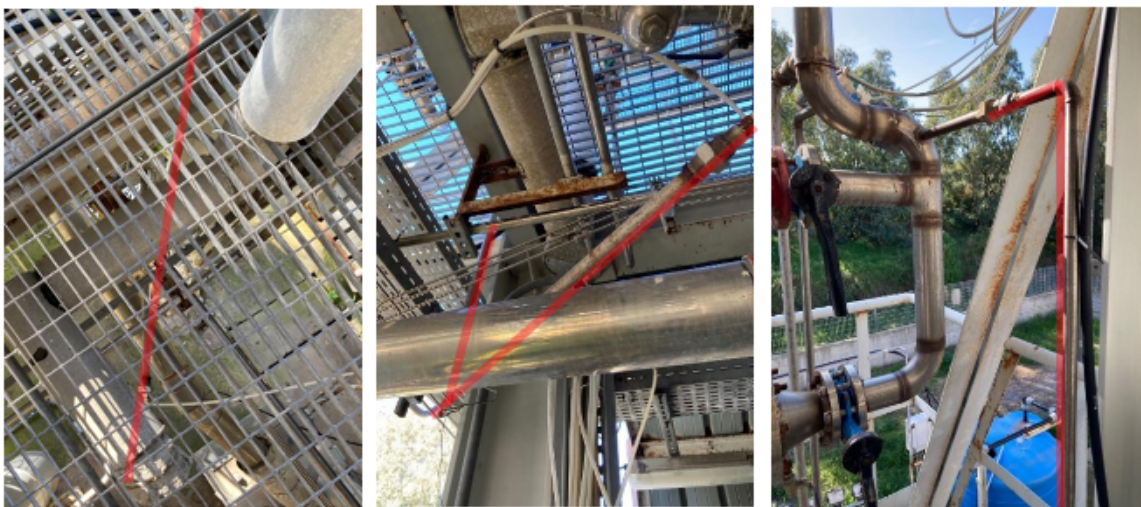
Figura 5. Tubazione syngas a vent a valle della sezione di desolforazione a caldo
