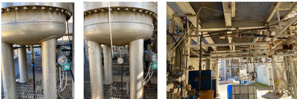
Figura 7. Reattori SAC e tubazioni di scarico in PE
