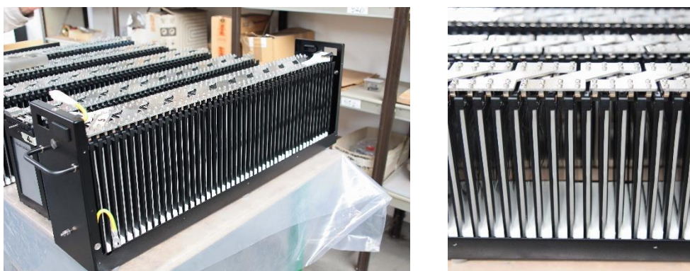
Figura 16 – Collegamento interno del contenitore originale delle celle
