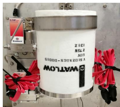
c) Particolare del preriscaldatore dei gas in ingresso al reattore alloggiato nel refrattario ceramico.
