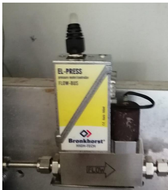
Figura 20. Particolare del regolatore/misuratore di pressione.
