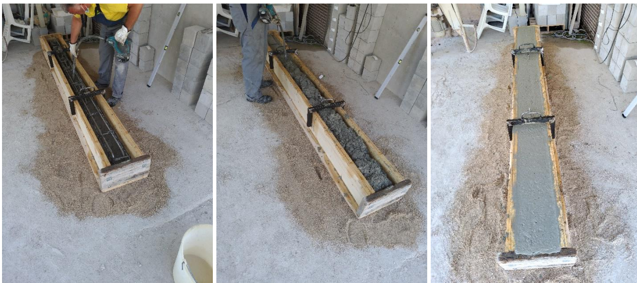
Figura 5-2 Sequenza relativa alle tre gettate separate. Nelle prime due si nota l'azione di vibratura del calcestruzzo mentre l'ultima è stata fatta dopo la vibratura e livellamento del materiale.
