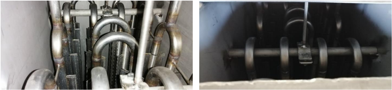
Figura 5- Scambiatore di calore alloggiato all'interno del contenitore.
