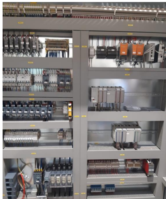
Figura 2.37. Interno del quadro elettrico P2G/L.
