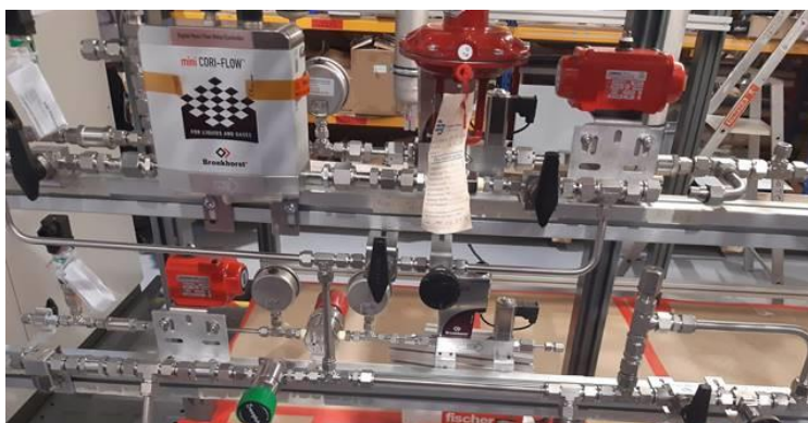
Figura 2.22. Esempio di strumentazione di misura montata sull'impianto P2G/L.
