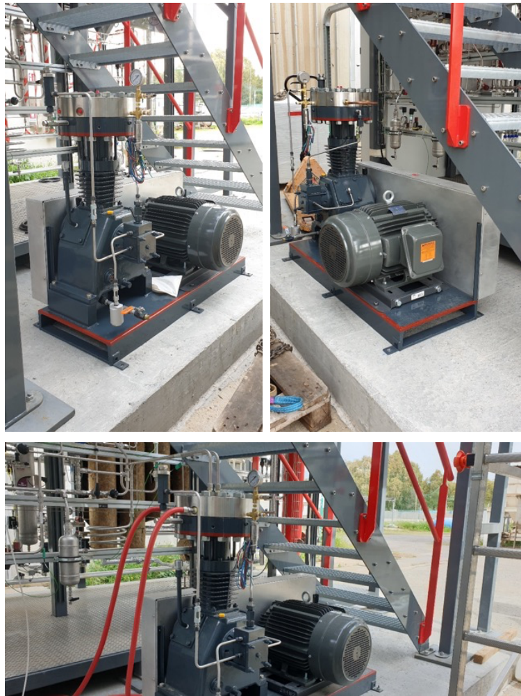
Figura 5.23. Posizionamento finale (in alto) e collegamento del compressore alla sezione di ricircolo dell'impianto (in basso).
