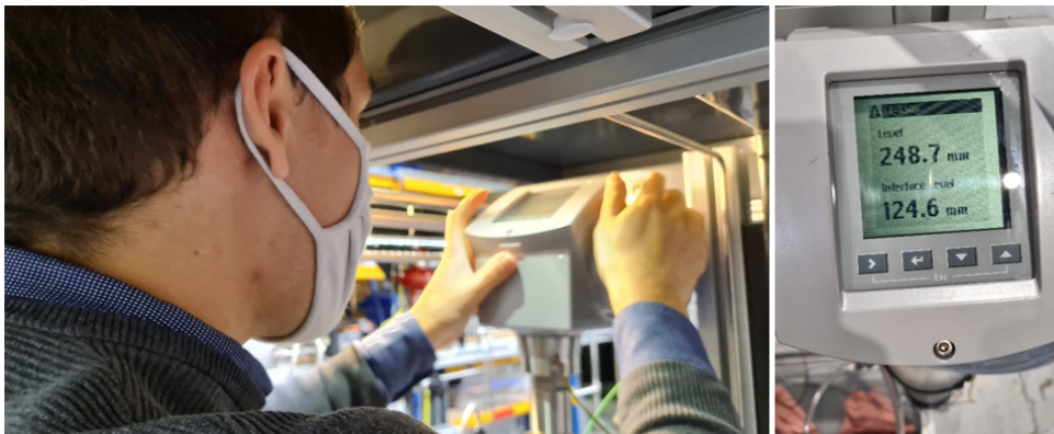
Figura 5.9. Calibrazione del livello nel separatore LP da parte dell'operatore (sinistra) e rilevamento dell'altezza di livello tramite il trasmettitore LT-3300 (destra).
