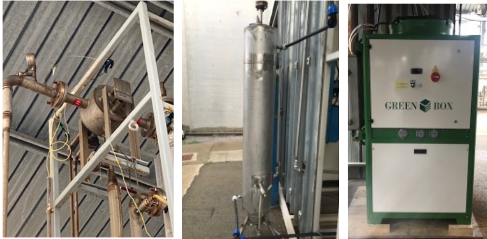
Figura 2.20. Scambiatore a piatti e gusci, polmone separatore di condense e chiller.
