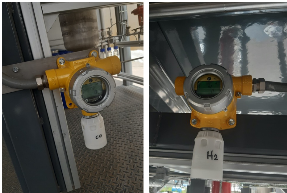
Figura 5.38. Rilevatori gas (CO e H 2 ).
