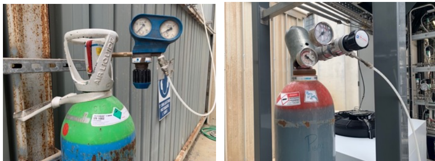
Figura 5.30. Bombe di aria e idrogeno per il funzionamento del gas-cromatografo, posizionate nei pressi dell'impianto.
