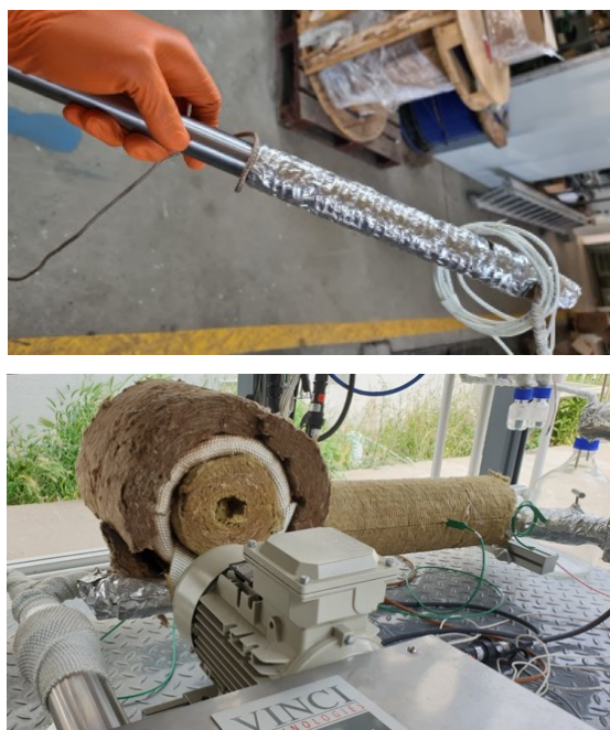
Figura 5.25. Riscaldatore elettrico aggiuntivo (in alto) e installazione in serie al primo riscaldatore originariamente installato (in basso).
