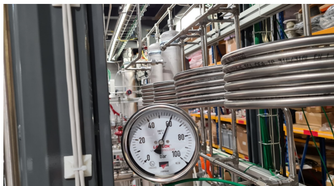
Figura 5.3. Valore di pressione raggiunto durante la prova di pressione negli scambiatori.
