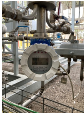
Figura 2.22. Densimetro installato sulla linea del solvente esausto.
