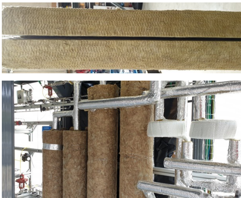
Figura 5.19. Lana di roccia pre-formata impiegata come primo rivestimento termico per tutti i reattori e i separatori dell'olio (in alto). Messa in opera del primo strato di rivestimento termico sui quattro separatori dell'olio (in basso).
