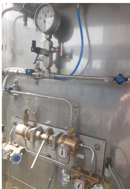
Figura 5.37. Centrale di riduzione della pressione dell'azoto.
