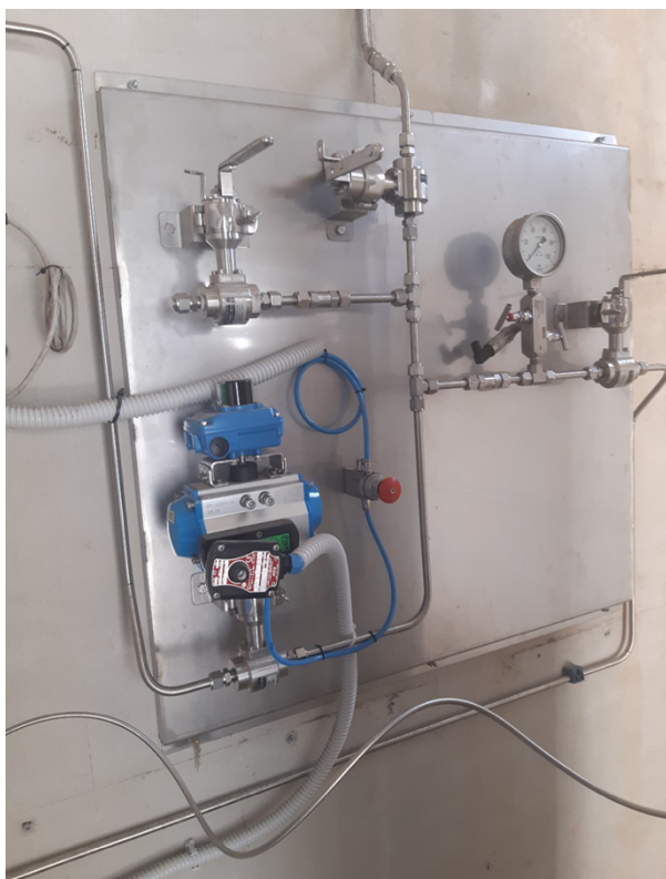
Figura 5.33. Centrale di riduzione della pressione dell'idrogeno.
