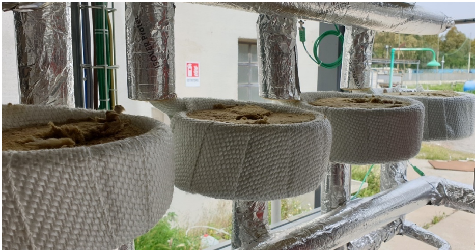
Figura 5.21. Realizzazione della coibentazione dello scambiatore di calore con il rivestimento iniziale di fibra di vetro.
