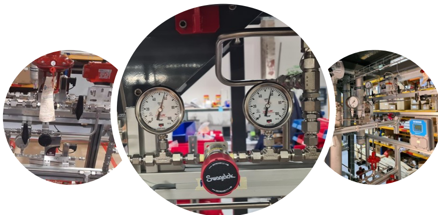
Figura 2.10. Esempio di strumentazione di misura montata sull'impianto.
