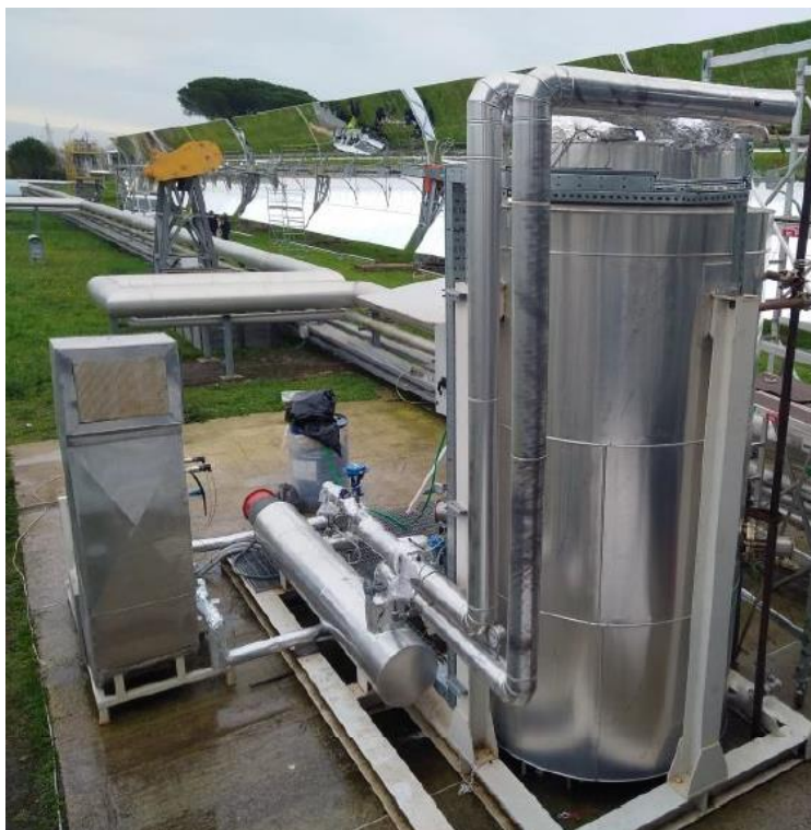
Figura 2. Il prototipo del sistema di accumulo a singolo serbatoio di tipo termoclino installato presso l’impianto PCS nel centro ENEA della Casaccia [3]
