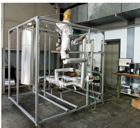
Figura 3-6 Prototipo LHC01 installato all'interno del dell'impianto ATES.
