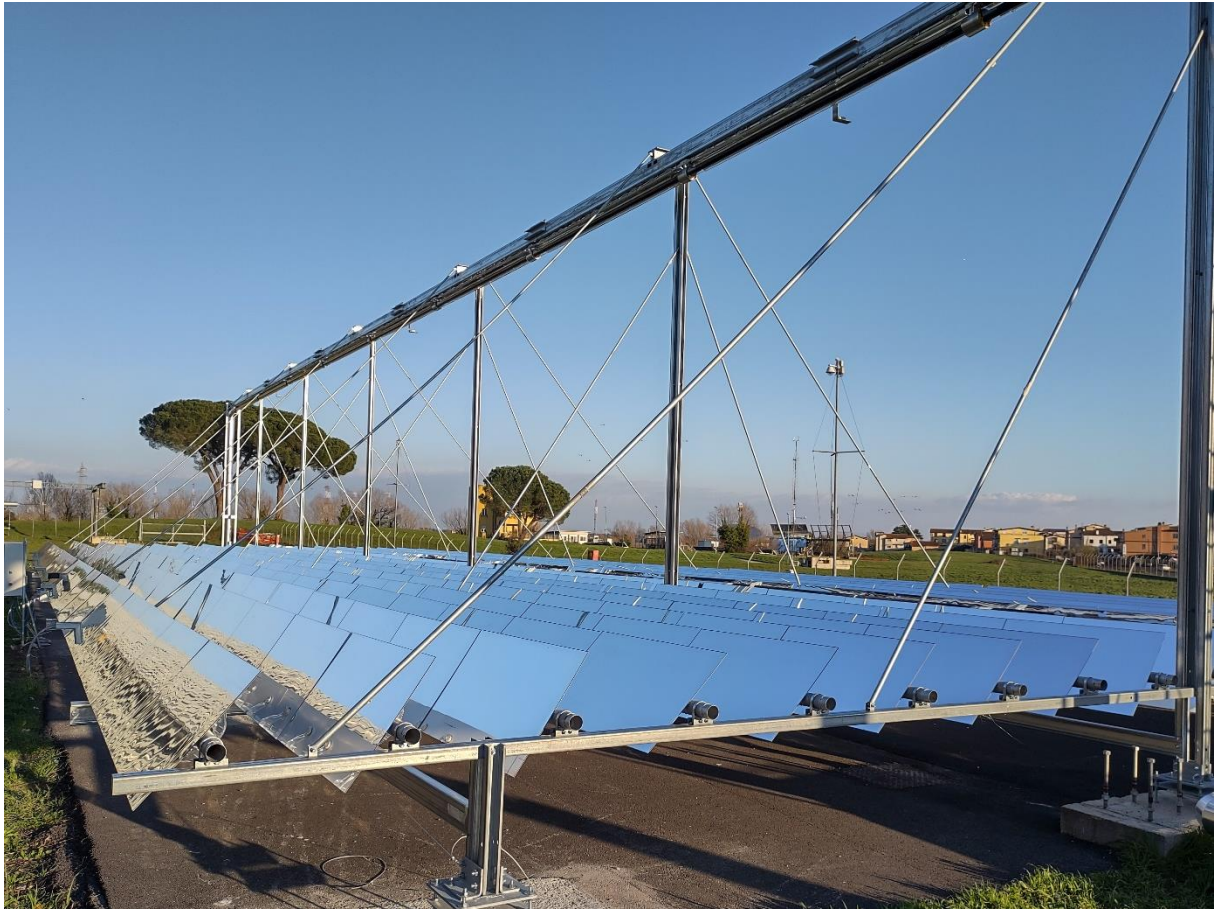
Figura 2. Collettore lineare Fresnel installato presso il CR ENEA Casaccia.
