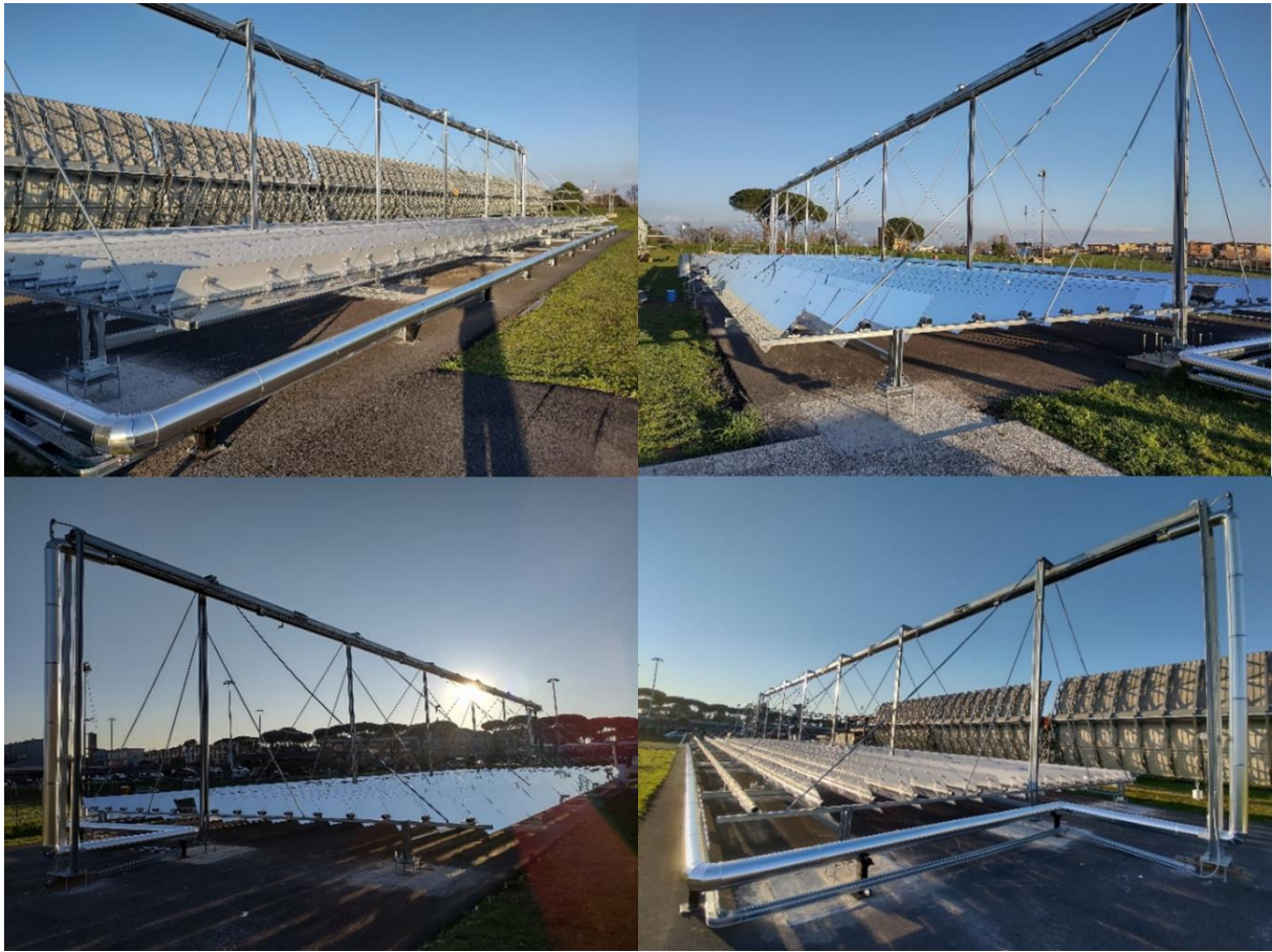
Figura 6. Collettore lineare Fresnel installato presso il CR ENEA Casaccia.
