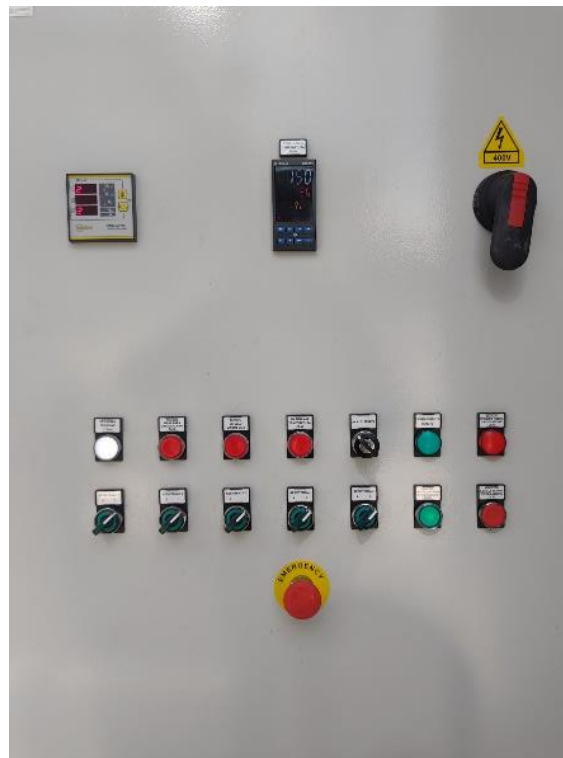
Figura 17. Pannello di comando locale del riscaldatore elettrico.
