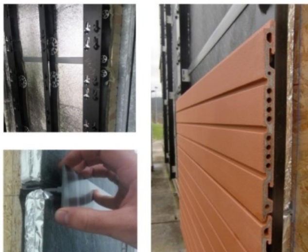
Figura 33. Dettagli sull'installazione del sistema di soluzioni di retrofitting esterno. Montaggio a parete degli elementi di fissaggio meccanico per VIP (a sinistra) e soluzione di facciata generale nel prototipo su piccola scala. Fonte: [95]
