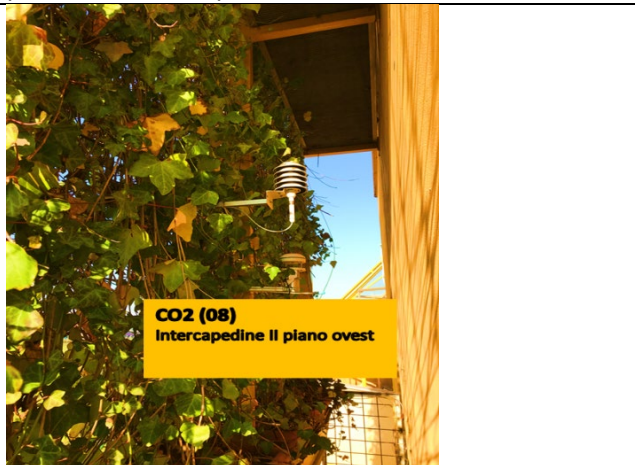
d. Intercapedine della parete esposta a Sud-Ovest (SO), II° piano: sensore CO 2 in area equidistante tra la parete verde e la parete dell'edificio
